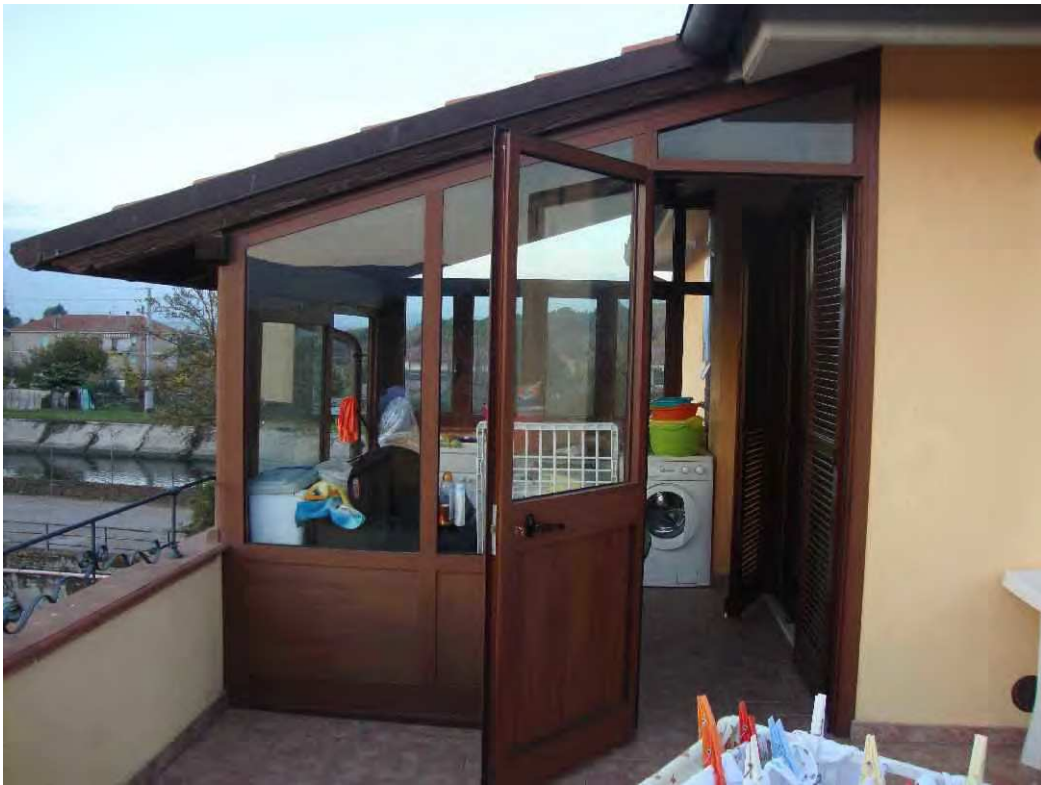
Foto 43 - Chiusura su terrazzo non autorizzata
