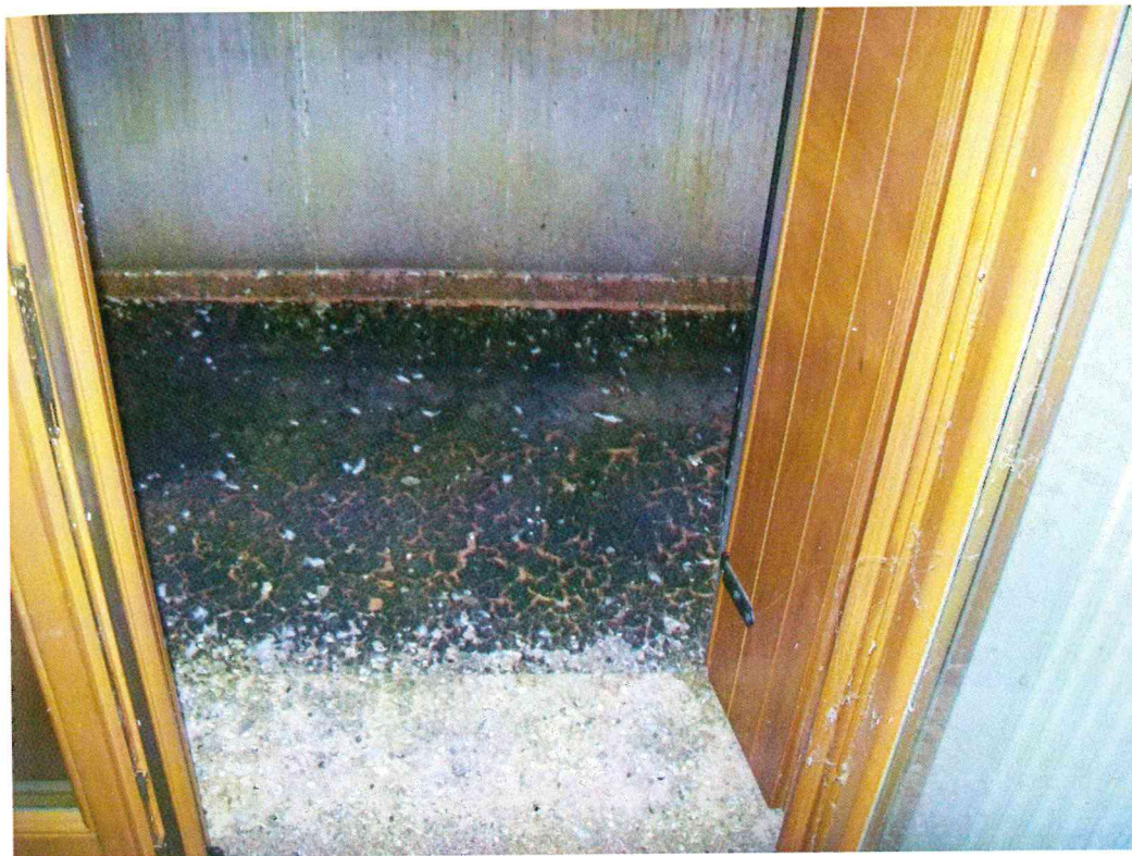
Foto 25 – Immobile B1 – Stato di fatto pavimentazione poggiolo.
