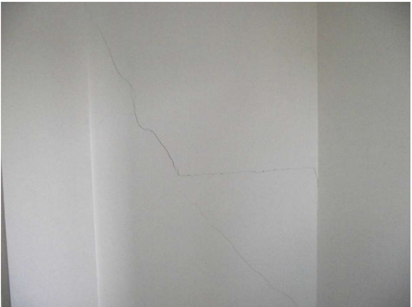
Foto 15 – fessura camera da letto (passante) verso camera matrimoniale
