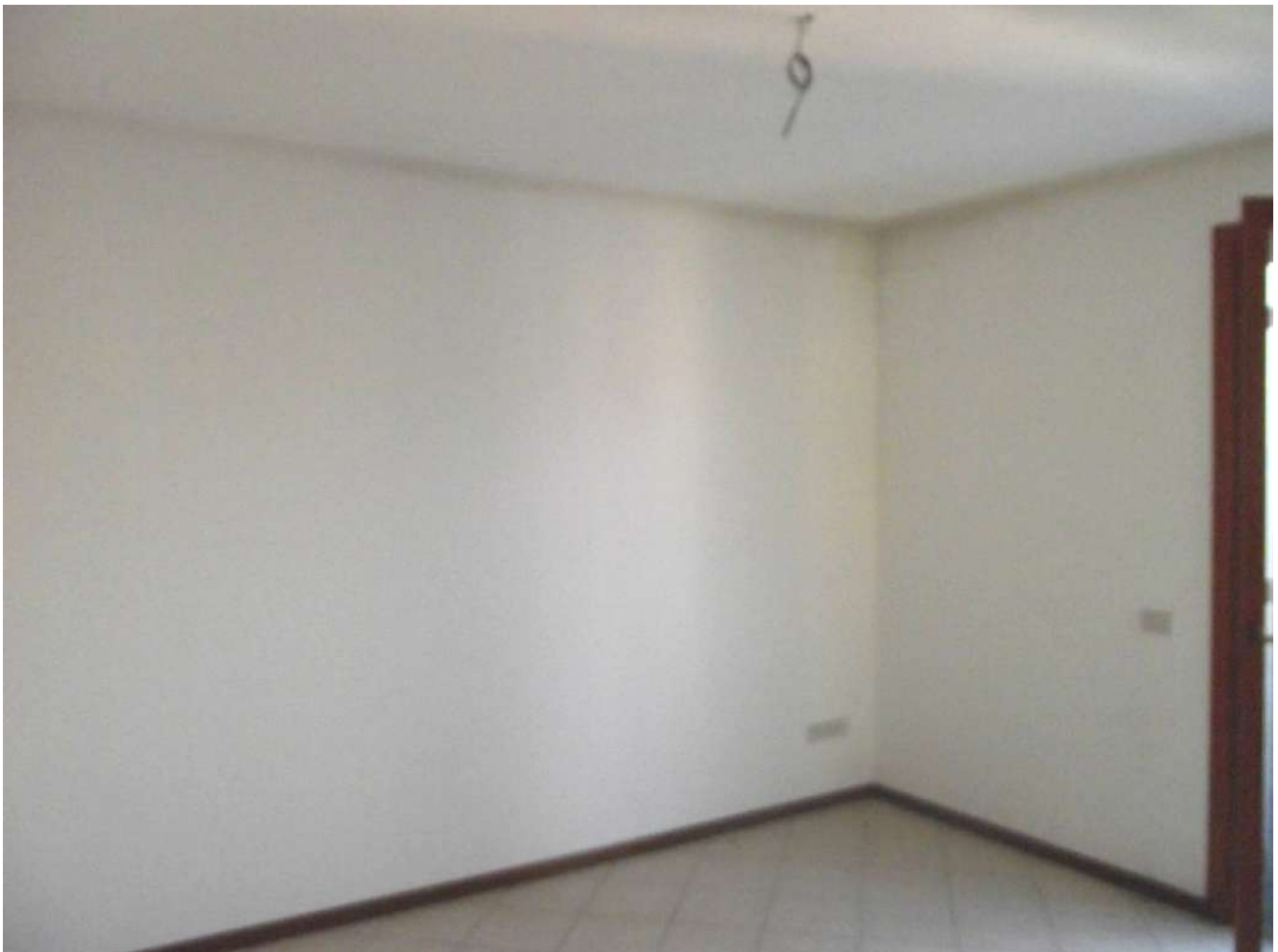
Foto 14 – camera da letto matrimoniale - muffe
