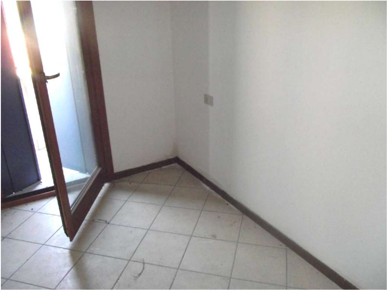
Foto 11 – camera da letto matrimoniale - muffe
