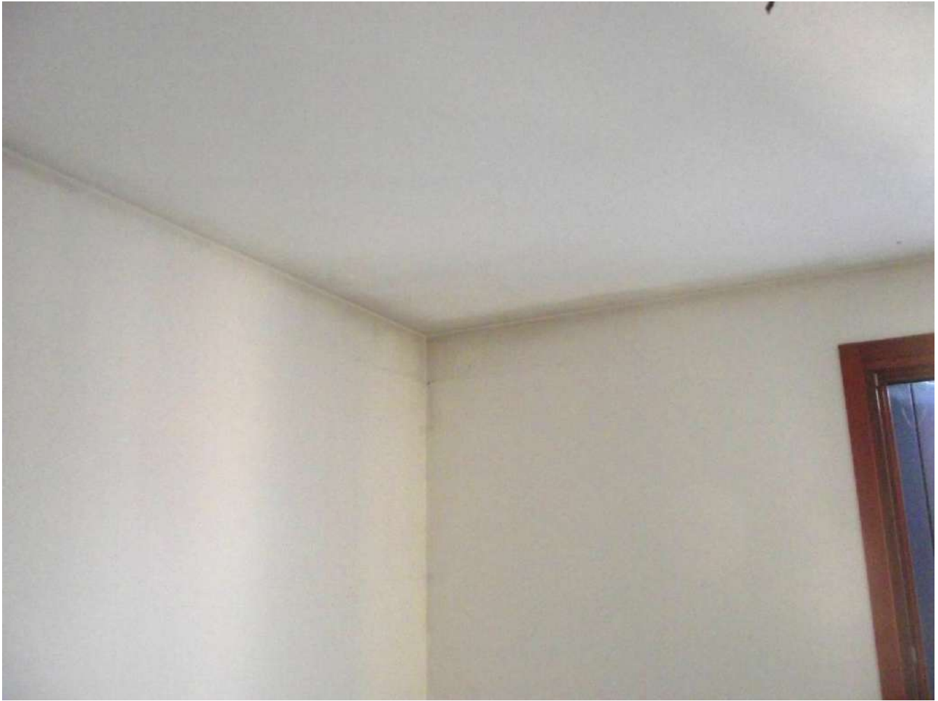
Foto 13 – camera da letto matrimoniale - muffe
