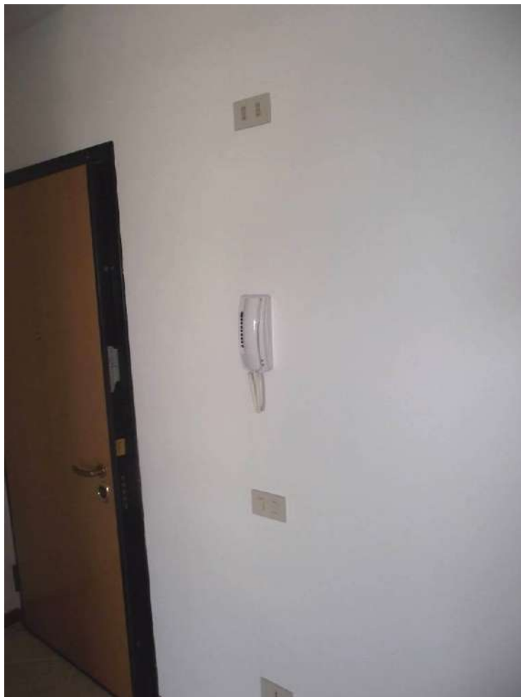
Foto 8 – fessura zona ingresso
