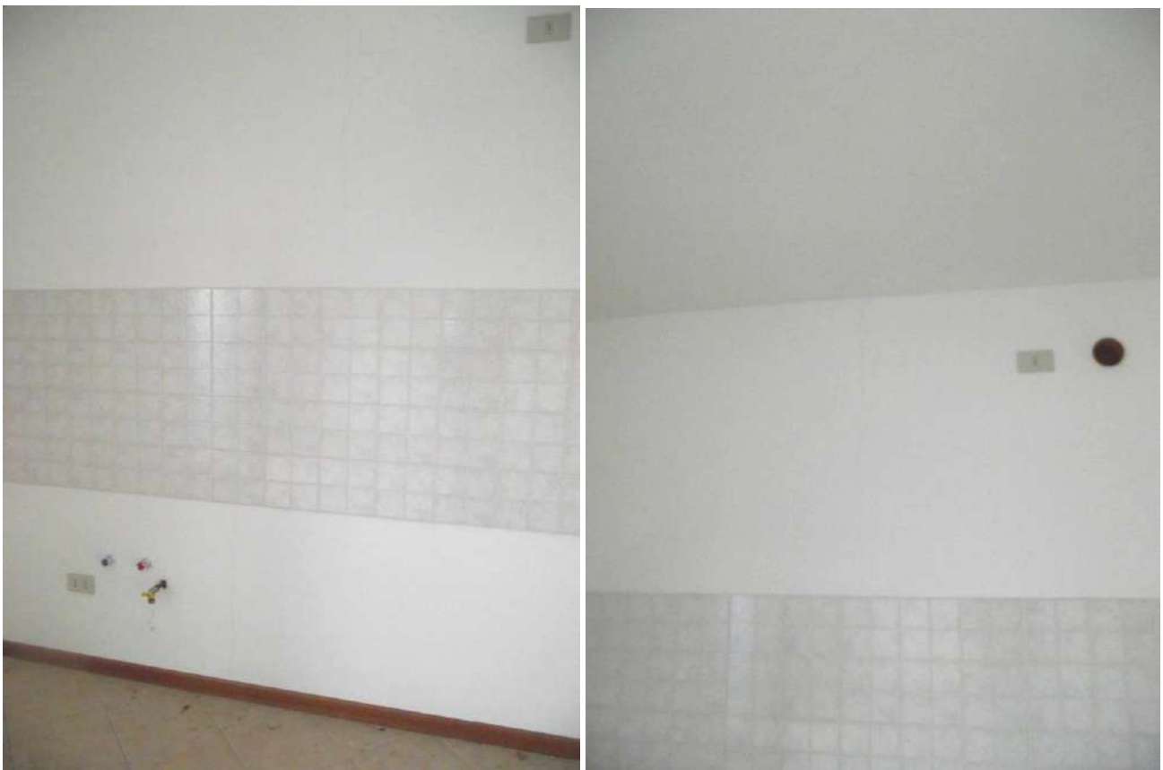
Foto 10 - 11 – fessura zona angolo cottura
