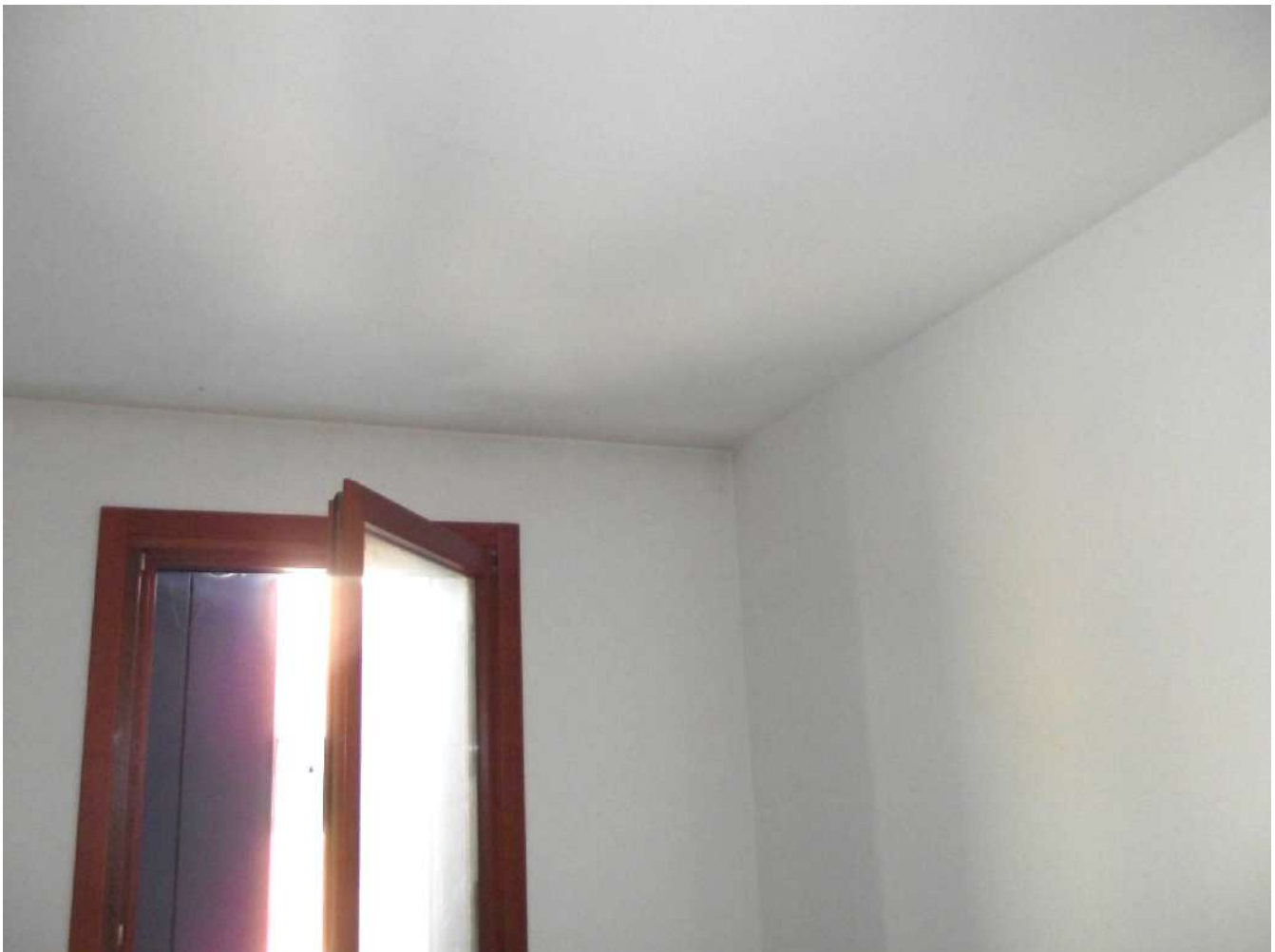
Foto 12 – camera da letto matrimoniale - muffe
