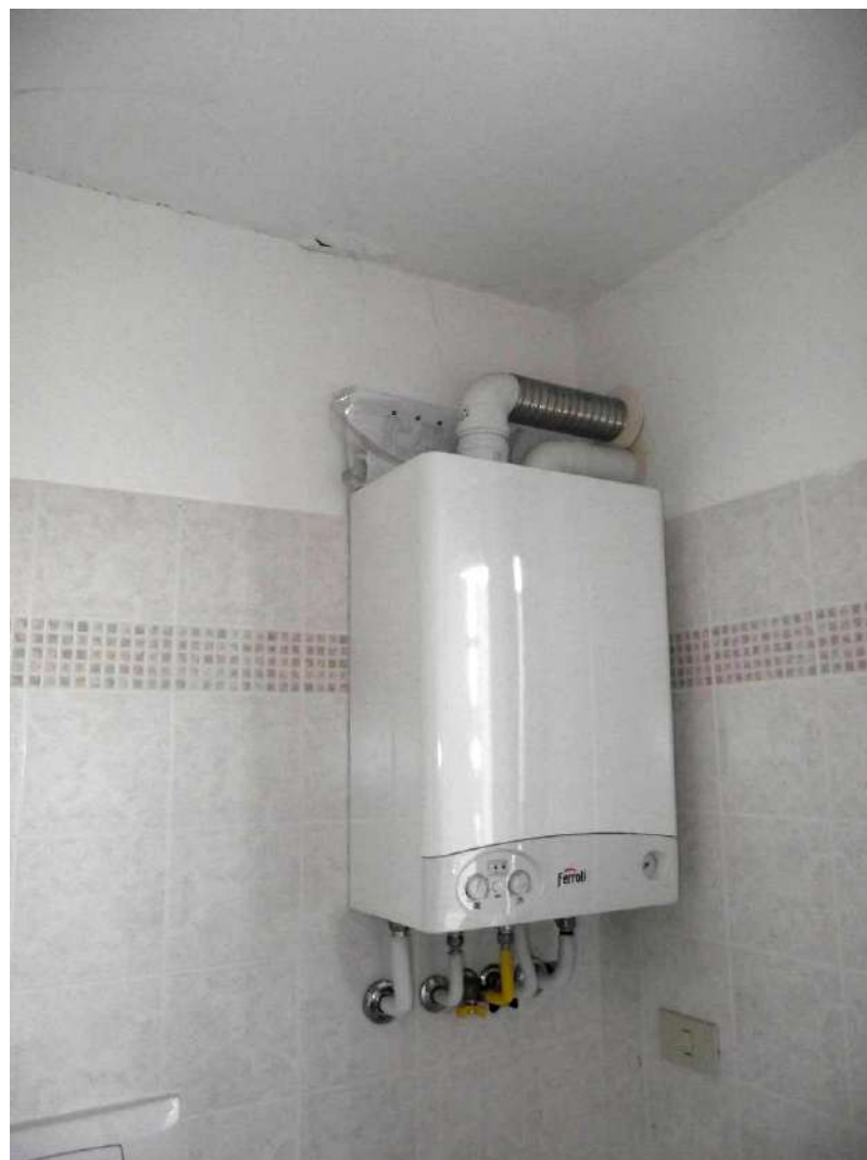
Foto 22 – caldaia e fessure
