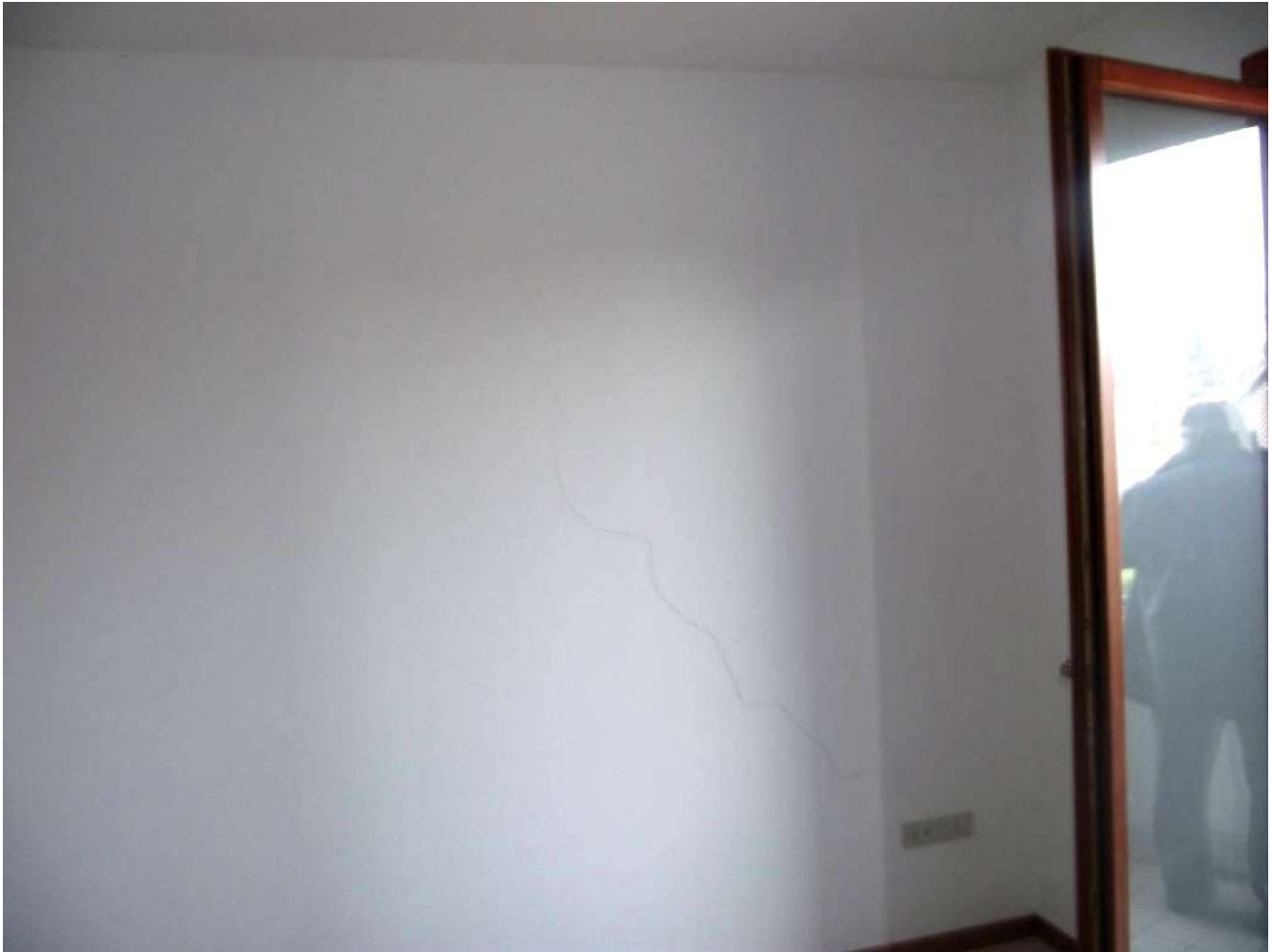
Foto 12 – fessura zona giorno (passante)
