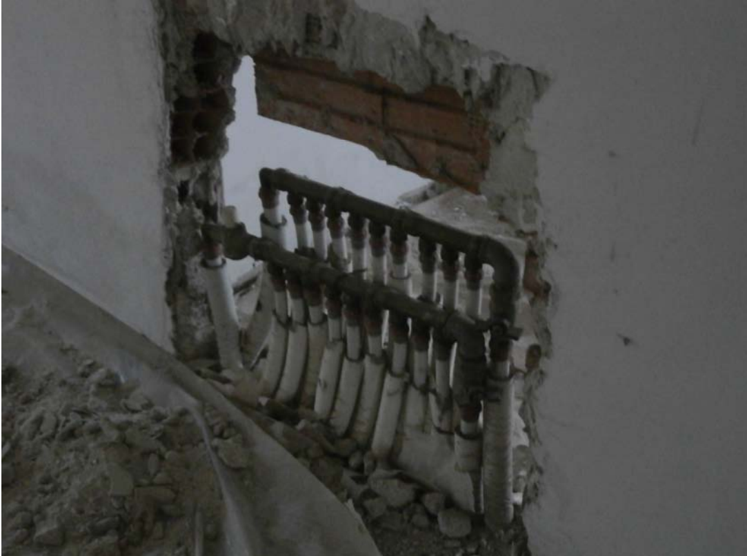
Edifici A, B e C: impiantistica rilevata
