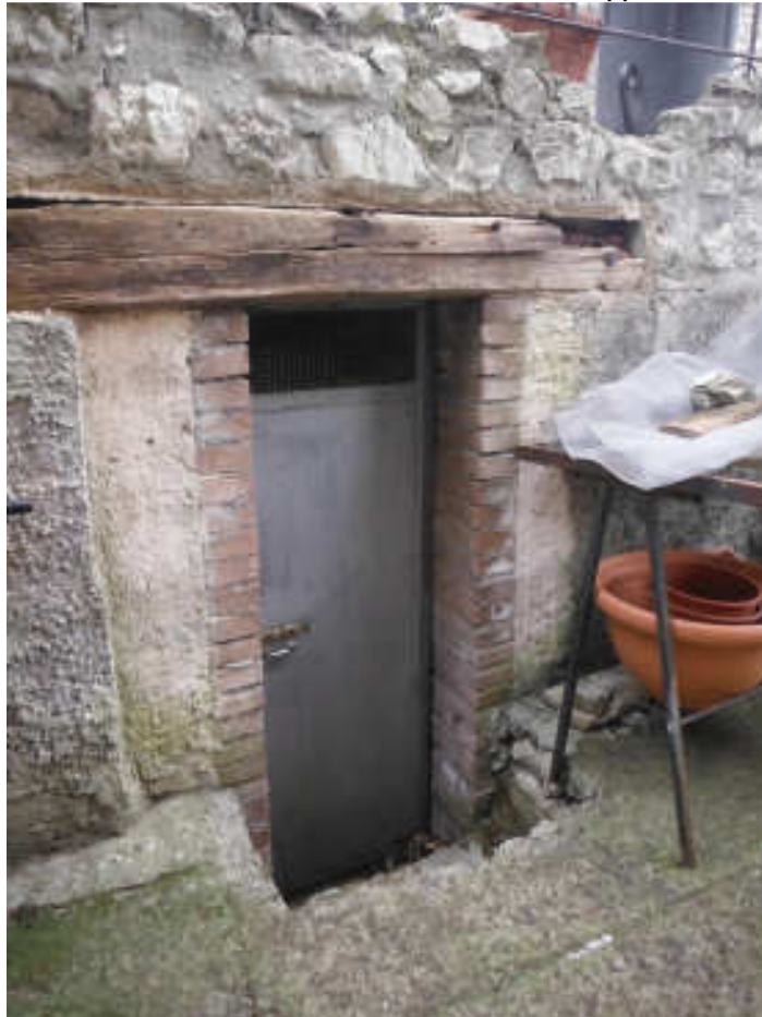
Ingresso cantina interrata (abusiva)
