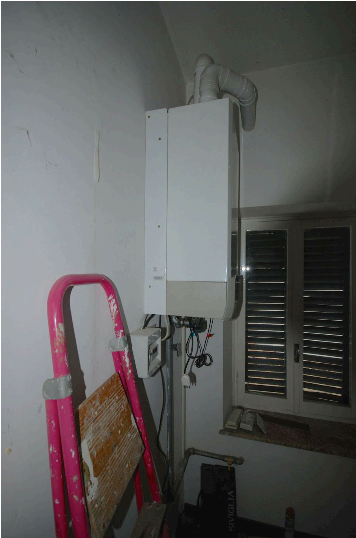
08_Foto del 26-08-2015_locale ingresso con caldaia a gas
