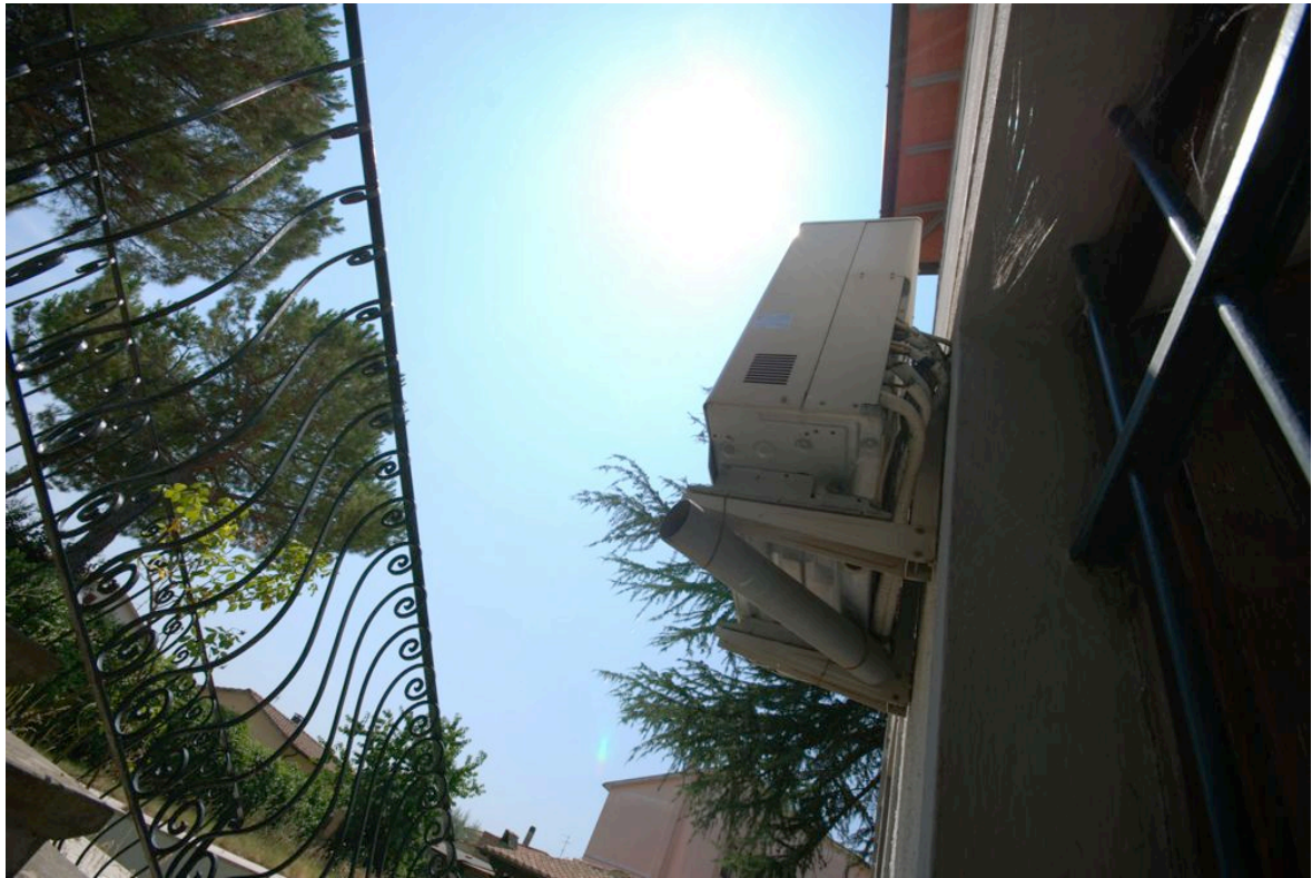
10_Foto del 22-07-2015_ unità esterna impianto di condizionamento e riscaldamento
