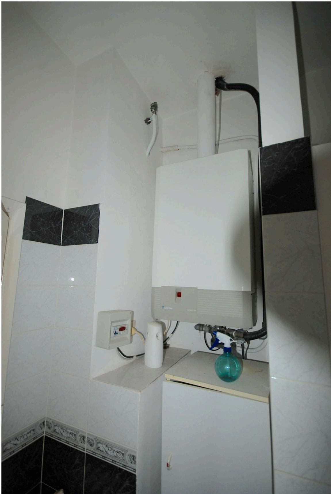
14_Foto del 26-08-2015_bagno con caldaia a gas
