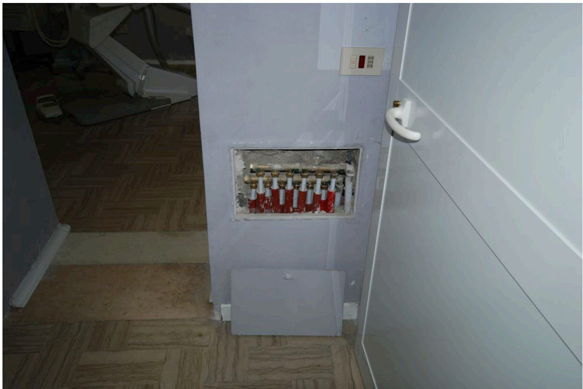
09_Foto del 22-07-2015_scatoia collettori termosifoni
