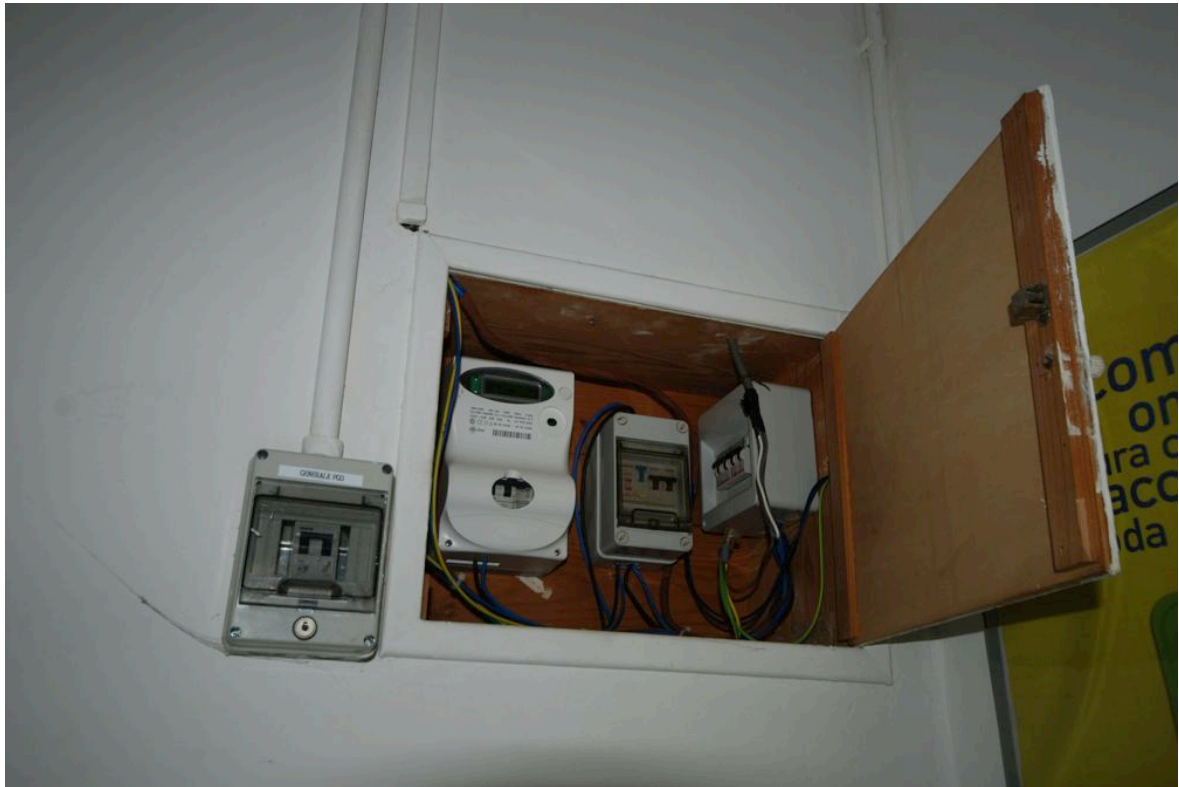
04_Foto del 22-07-2015_quadro elettrico e contatore
