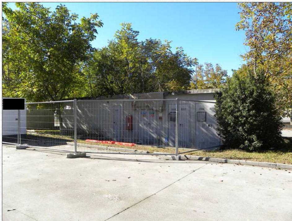
AT S.r.l. - compendio in Brugnera (PN): cabina elettrica (angolo Sud-Ovest)
