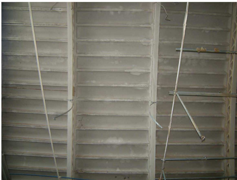
Prata di Pordenone, Particella 629 – Il Capannone, zona interessata da percolazione di acqua meteorica provenienti dalla copertura.
