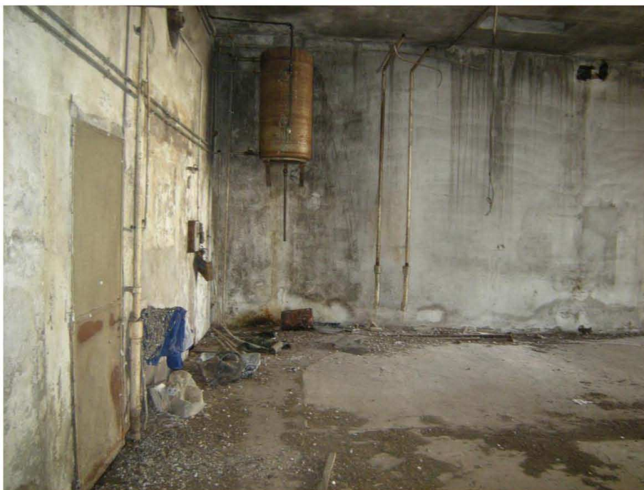
Prata di Pordenone, Particella 629 – Il locale con destinazione d'uso Centrale Termica.
