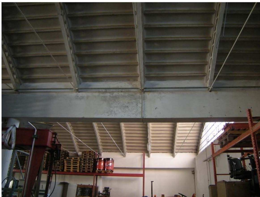
Prata di Pordenone, Particella 629 – Il Capannone, zona interessata da percolazione di acqua meteorica provenienti dalla copertura.
