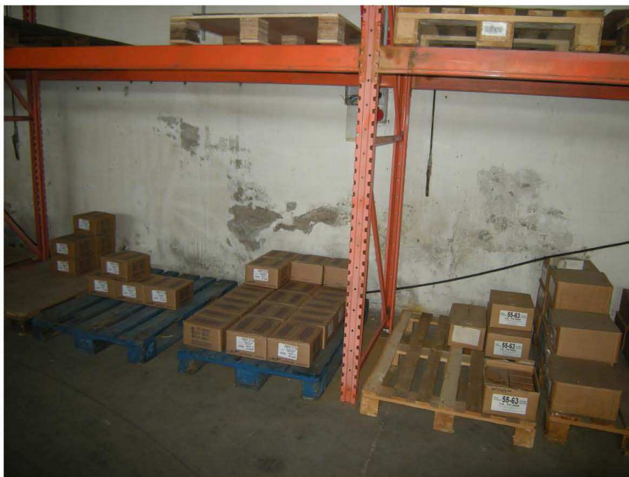
Prata di Pordenone, Particella 629 – La parete a sud-ovest del Capannone e i danni agli intonaci.
