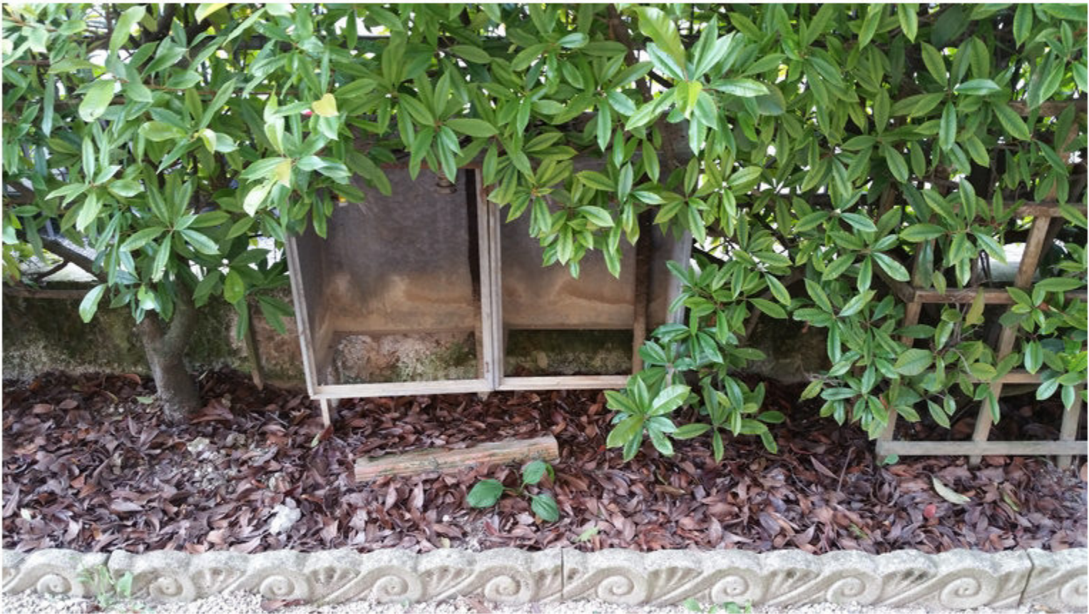
23 - particolare cassette gas metano
