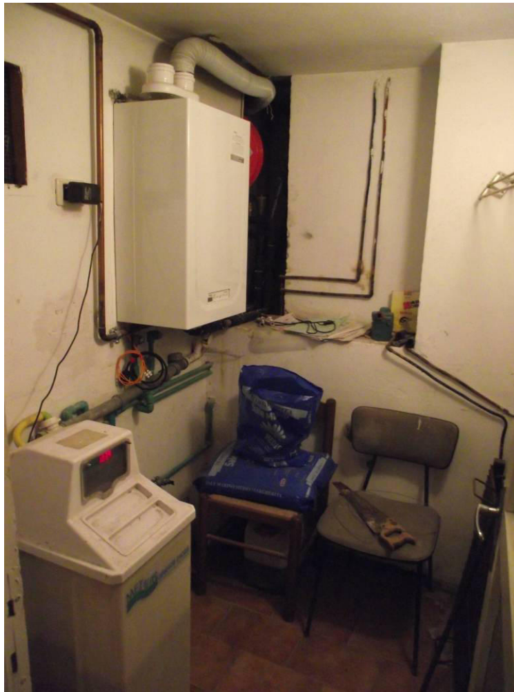
Foto 15 – P.T. centrale termica
