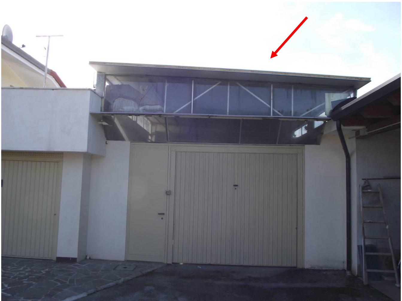
Foto 38 – deposito (freccia rossa) abusivo
