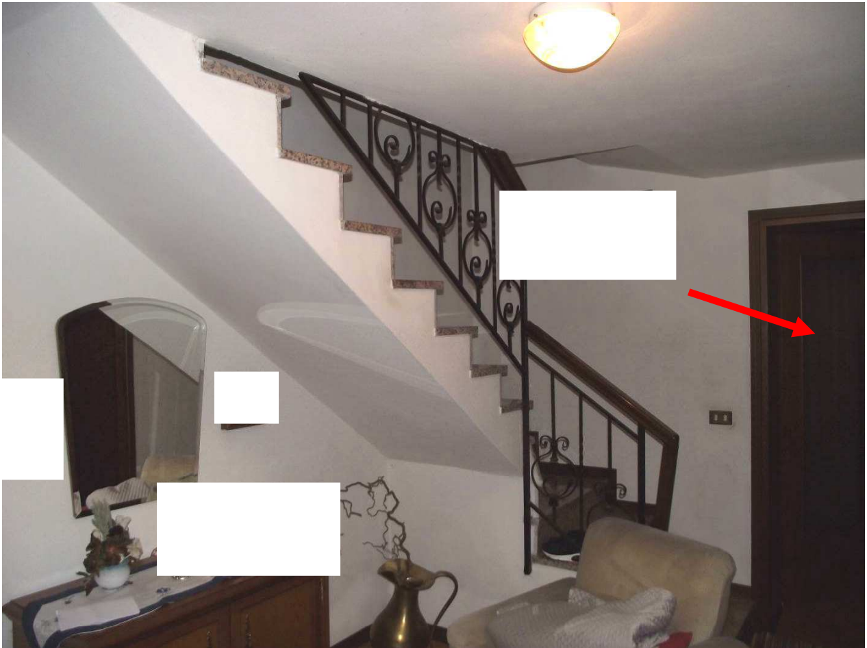
Foto 19 – scala di accesso al seminterrato – indicata porta di accesso alla zona lavanderia abusivamente realizzata
