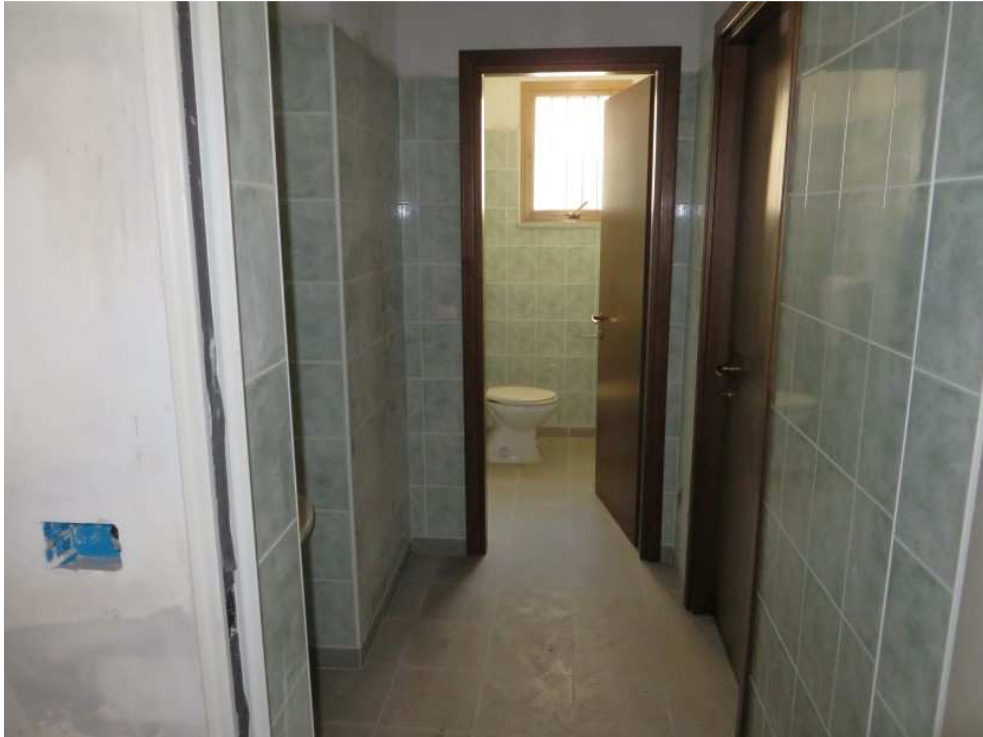
FOTO 11: SERVIZI SU ZONA MAGAZZINO (Piano Terra)
