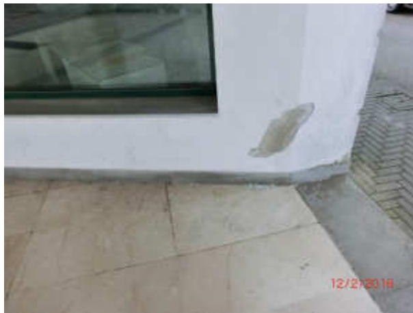
particolare difetti presenti nelle murature del negozio
