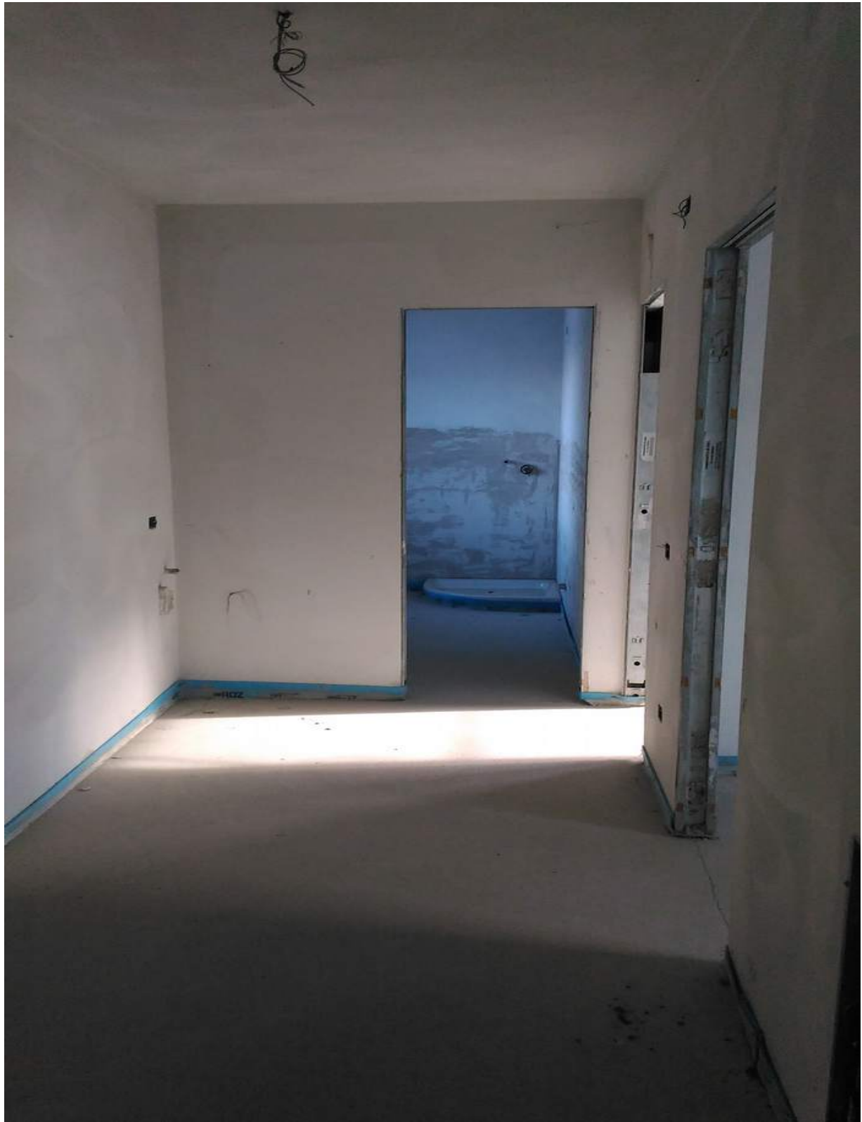
Foto n° 25 - 05/01/2017 - Comune di Concordia Sagittaria, foglio 13, part. 465, sub.7 - Disimpegno. Sullo sfondo visibile la porta di accesso al bagno. Sulla destra visibili gli accessi alle camere.
