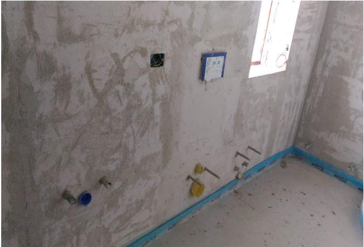
Foto n° 29 - 05/01/2017 - Comune di Concordia Sagittaria, foglio 13, part. 465, sub.7 - Bagno. Particolare dell'impianto idraulico.
