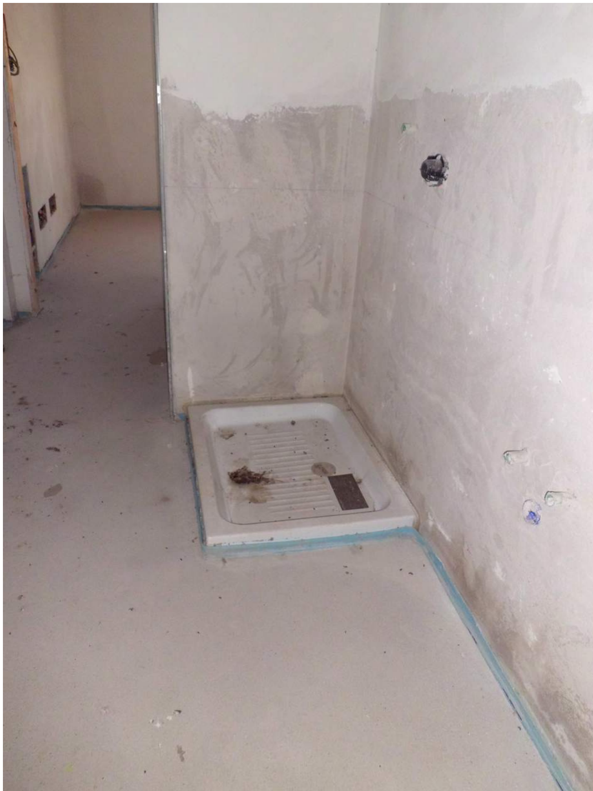
Foto n° 8 - 05/01/2017 - Comune di Concordia Sagittaria, foglio 13, part. 465, sub.4 - Stanza da bagno. Come visibile mancano i sanitari ed è stato posizionato solamente il piatto doccia.
