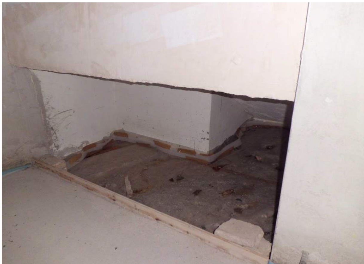
Foto n° 9 - 05/01/2017 - Comune di Concordia Sagittaria, foglio 13, part. 465, sub.4 - Stanza da bagno. Particolare della parete sud che attualmente permette l'accesso al sottoscala.
