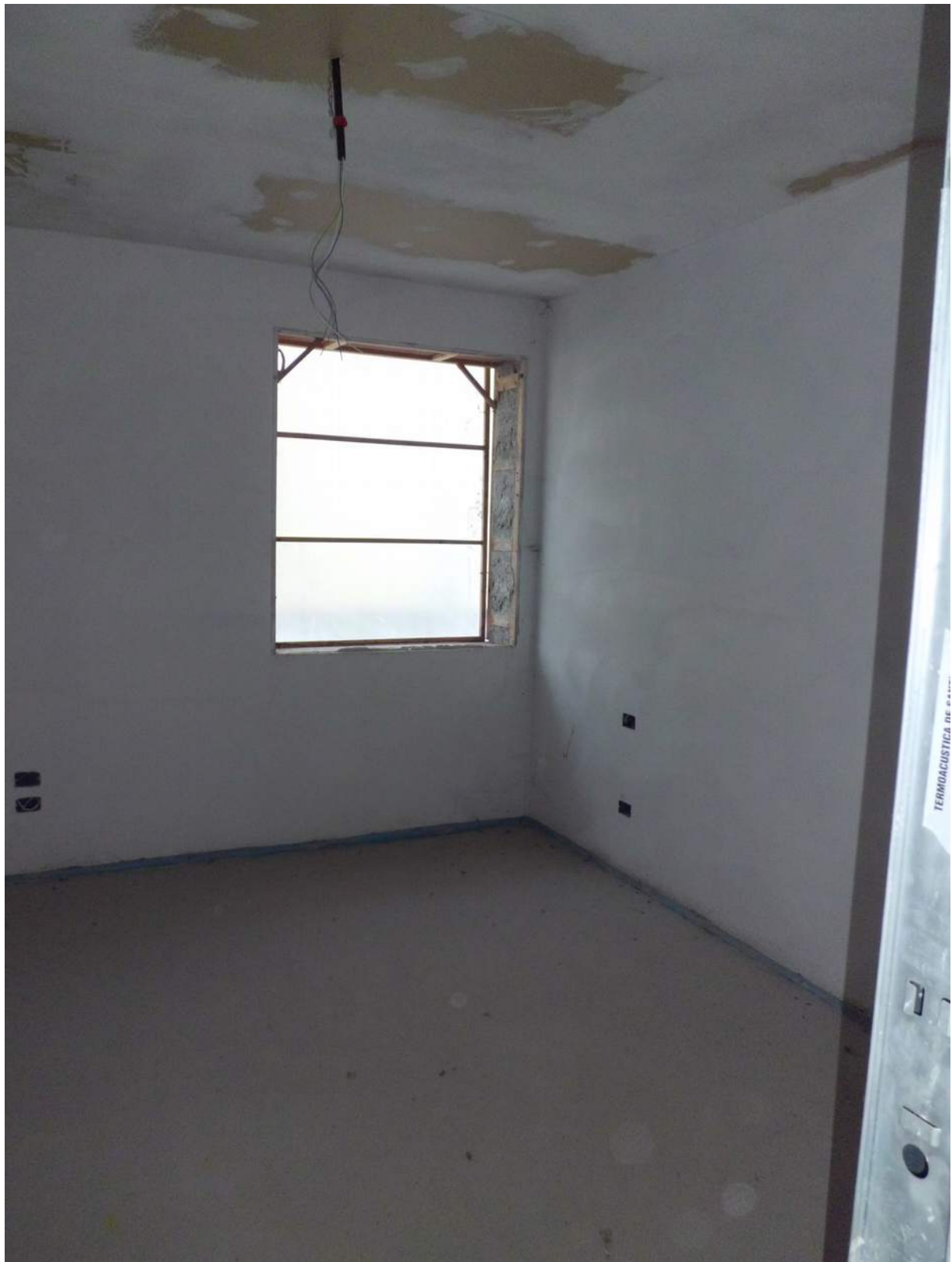
Foto n° 14 - 05/01/2017 - Comune di Concordia Sagittaria, foglio 13, part. 465, sub.5 - Stanza sulle tavole di progetto identificata come camera.
