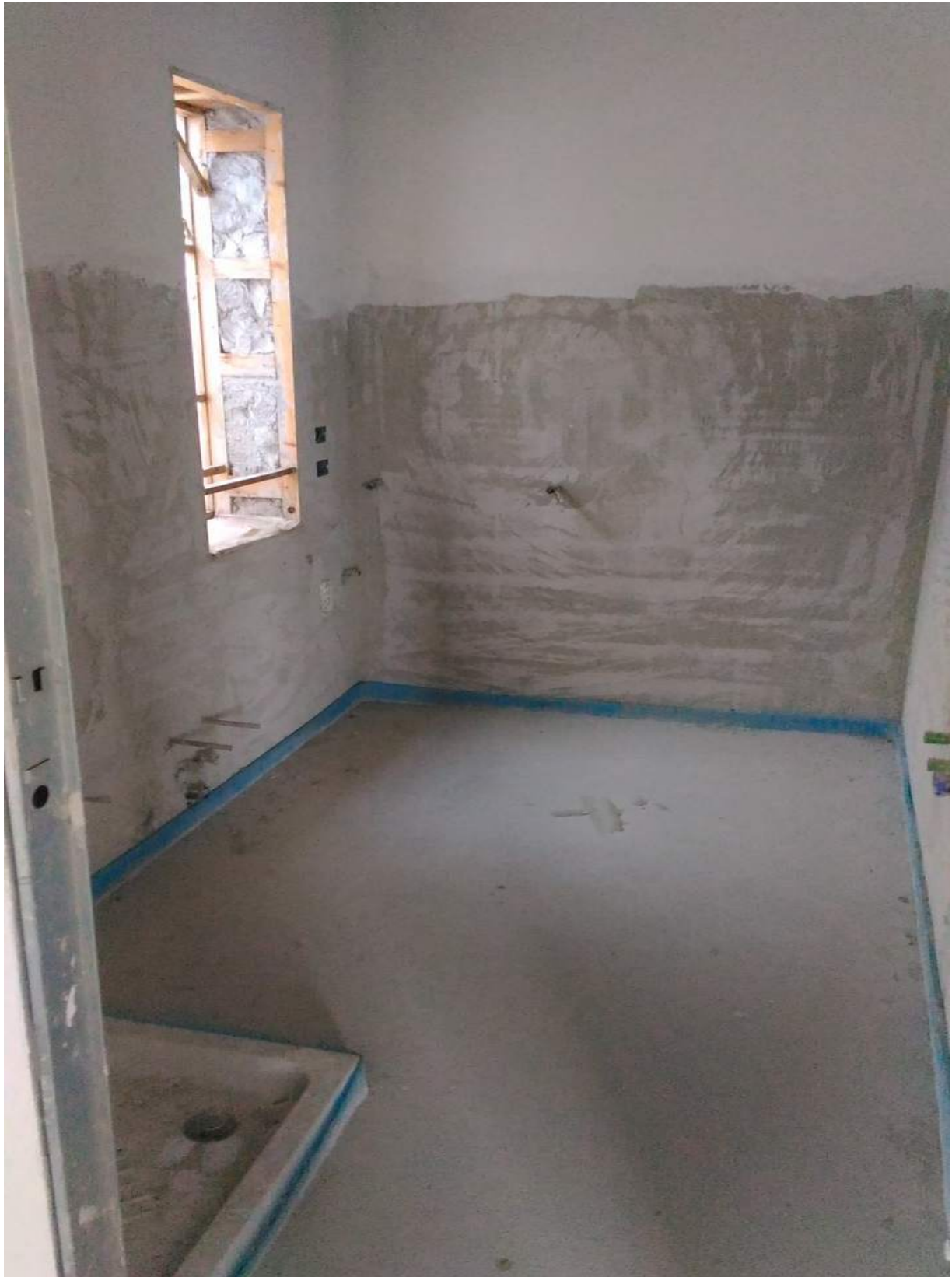
Foto n° 21 - 05/01/2017 - Comune di Concordia Sagittaria, foglio 13, part. 465, sub.6 - Bagno. Come visibile sono presenti i tubi dell'impianto idraulico ma mancano i sanitari. È posizionato solamente il piatto doccia.
