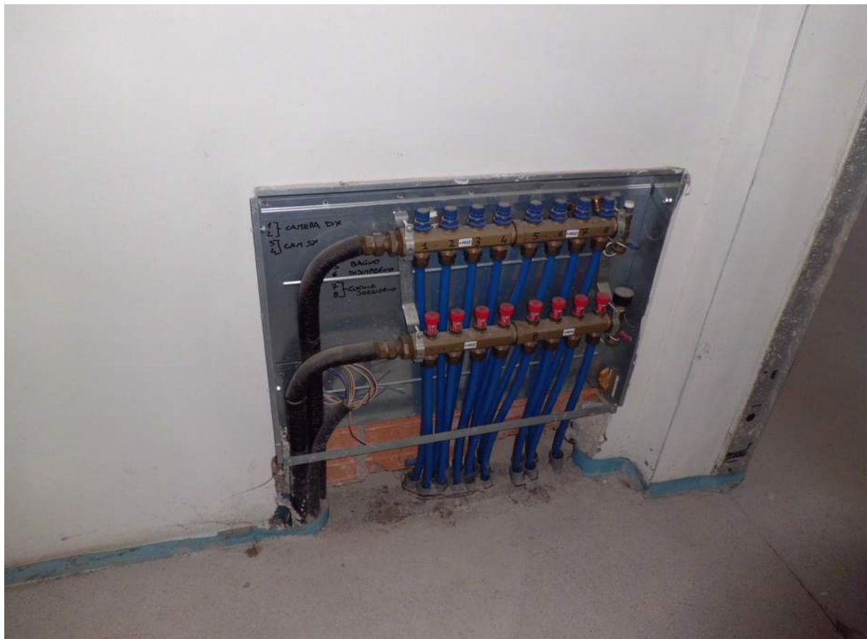
Foto n° 12 - 05/01/2017 - Comune di Concordia Sagittaria, foglio 13, part. 465, sub.5 - Disimpegno. Particolare dell'impianto di riscaldamento.
