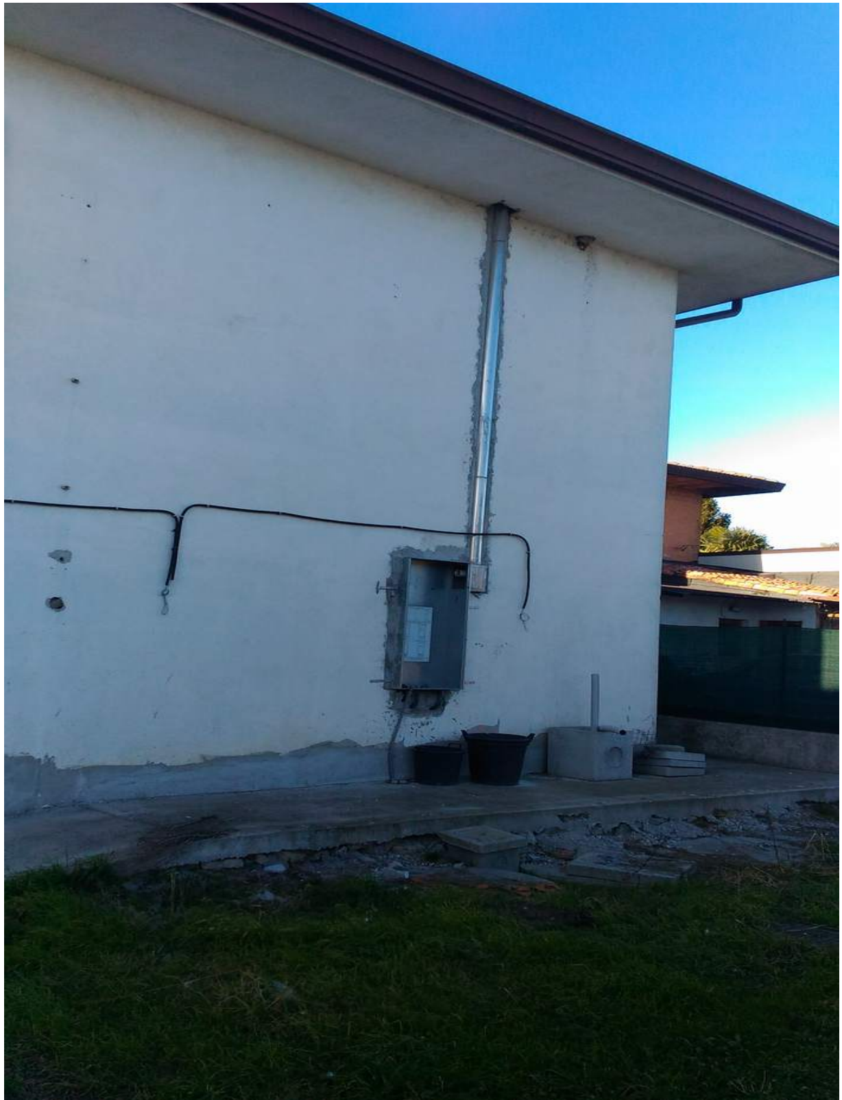
Foto n° 31 - 05/01/2017 - Comune di Concordia Sagittaria, foglio 13, part. 465, sub.8 – Particolare del vano caldaia posto esternamente al fabbricato.
