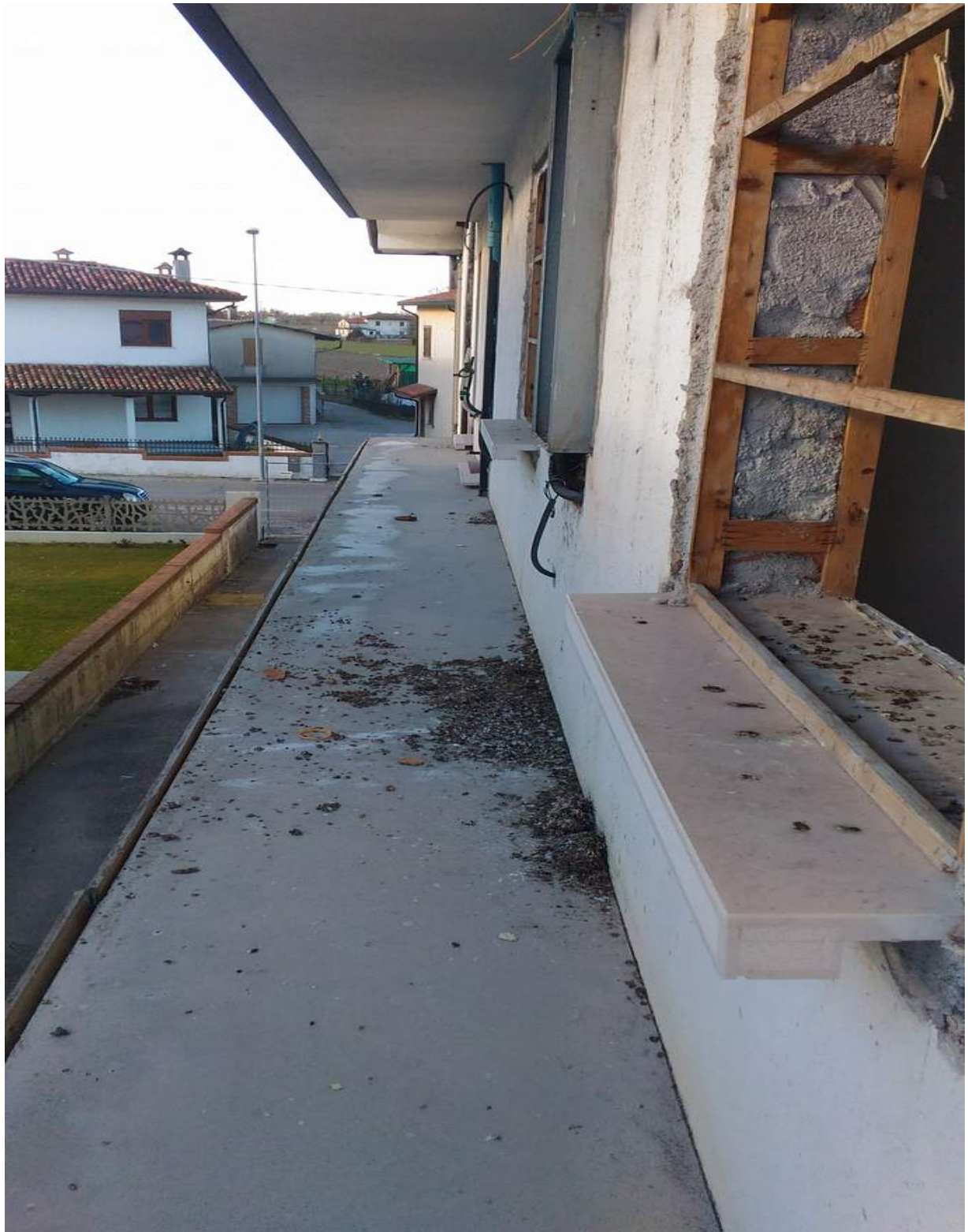
Foto n° 30 - 05/01/2017 - Comune di Concordia Sagittaria, foglio 13, part. 465, sub.7 - Terrazza esterna priva di piastrelle e ringhiere.
