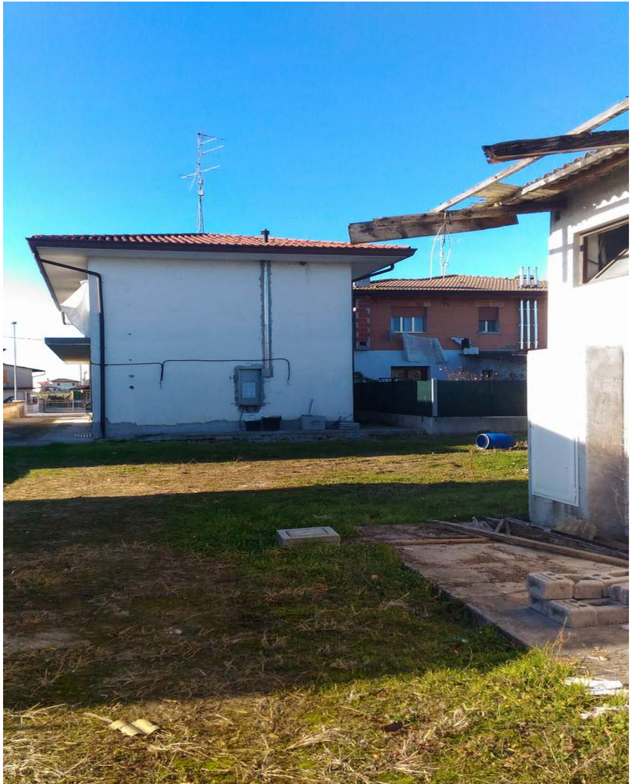
Foto n° 43 - 05/01/2017 - Comune di Concordia Sagittaria, foglio 13, part. 465-634 - Superficie della particella 465 e 634. Visibile il lato ovest del fabbricato in ristrutturazione. Sulla destra visibile l'angolo del fabbricato ex-falegnameria.
