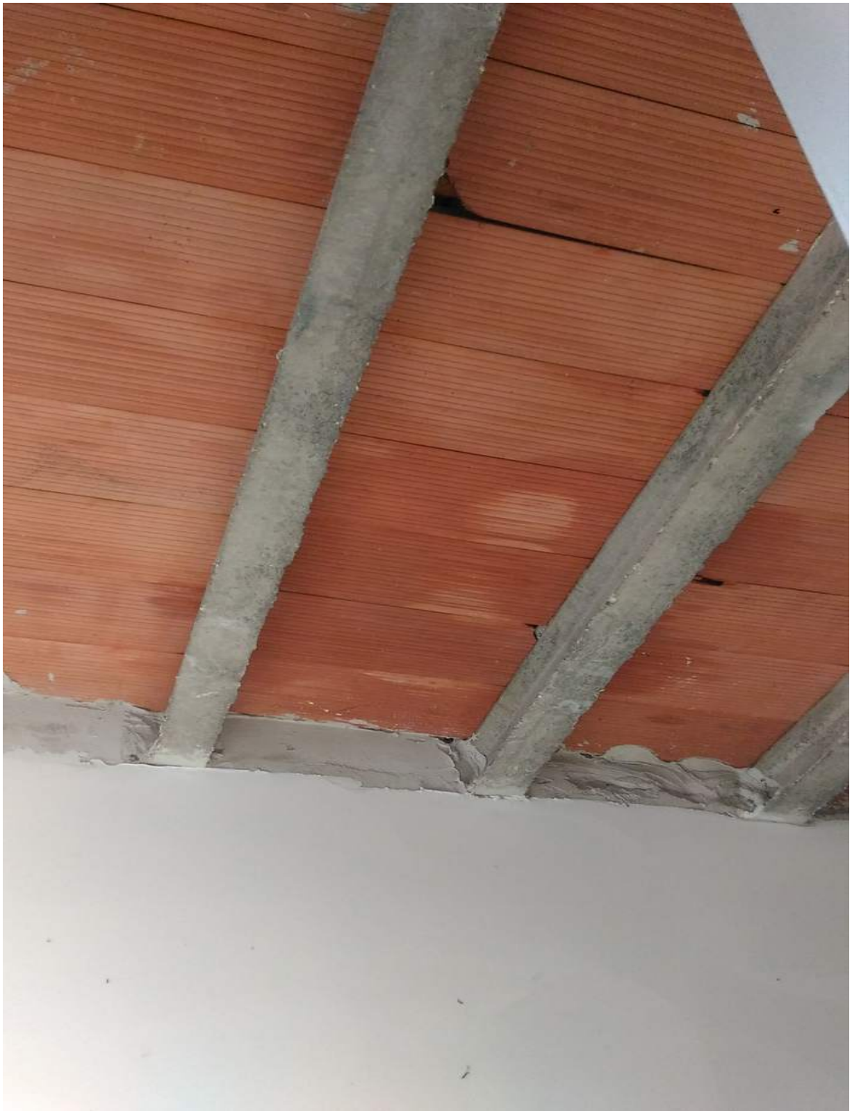
Foto n° 24 - 05/01/2017 - Comune di Concordia Sagittaria, foglio 13, part. 465, sub.7 - Soffitta. Particolare del tetto di copertura dove sono visibili delle macchie di umidità.
