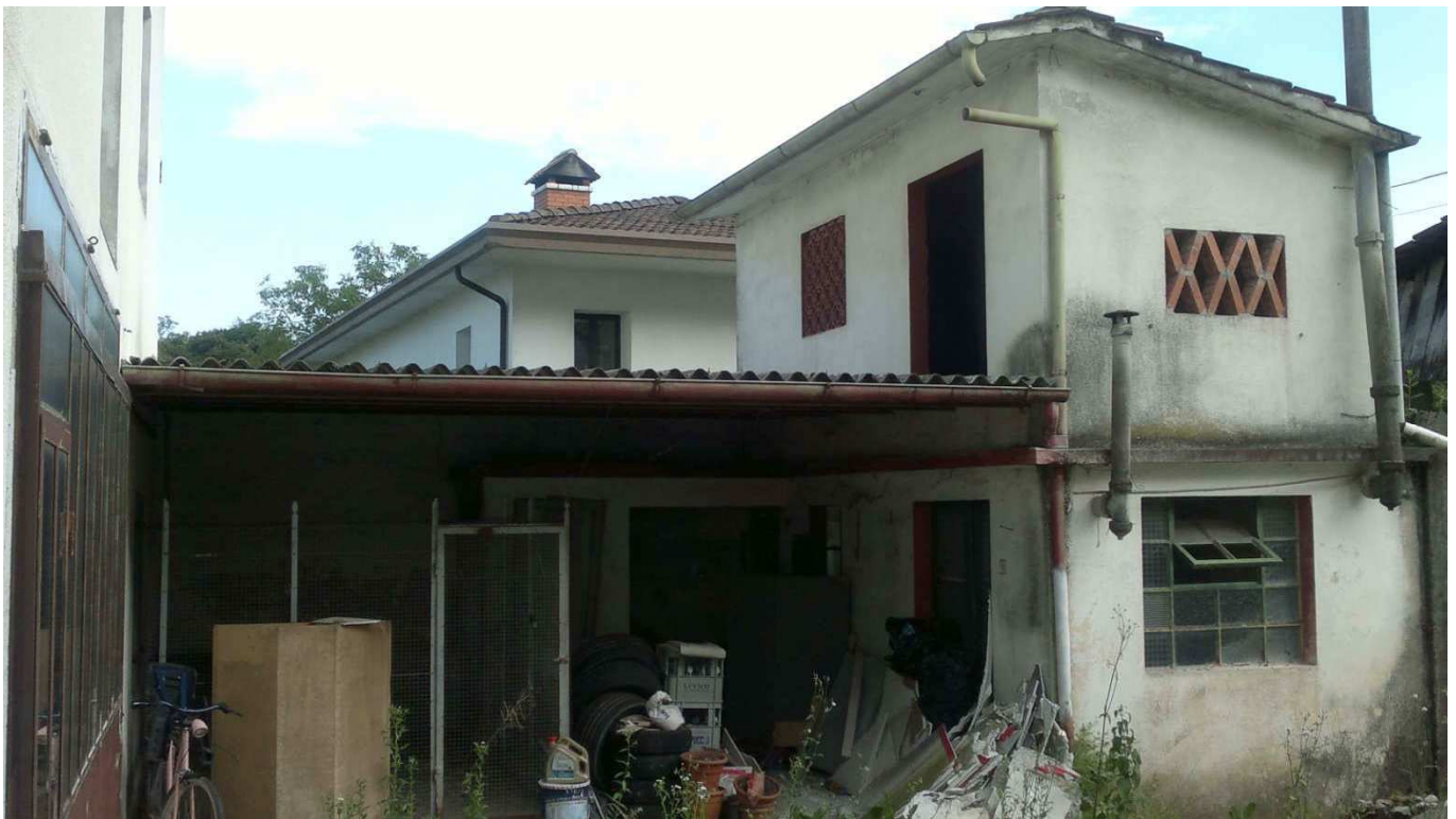
Foto 10: Tettoia (Sub.5) posta lungo il confine Sud-Est della proprietà oggetto di esecuzione immobiliare.
