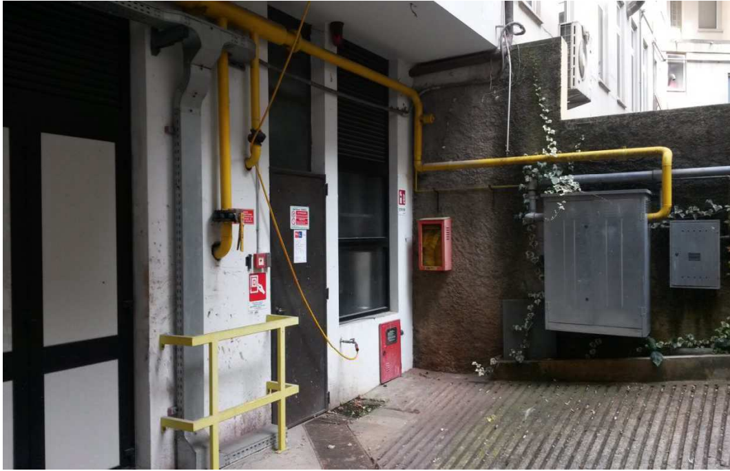
FOTO CENTRALE TERMICA PIANO INTERRATO
