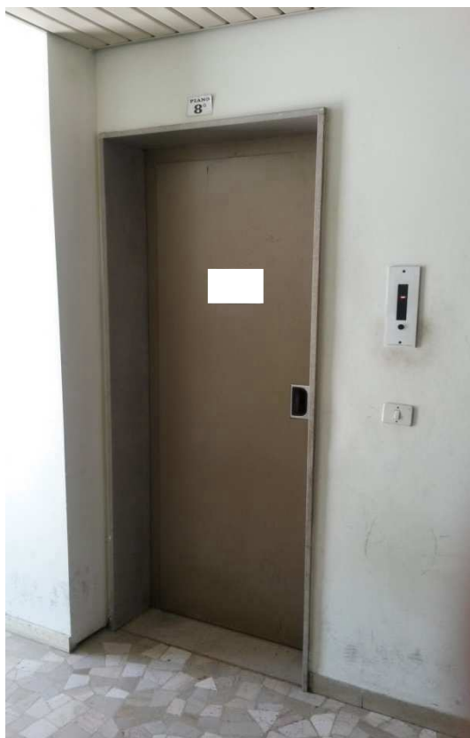
FOTO 10 VANO ASCENSORE P. OTTAVO
