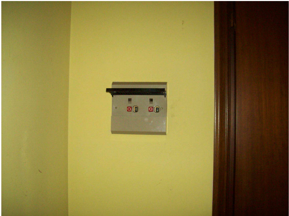
Foto 8: Quadro elettrico appartamento
