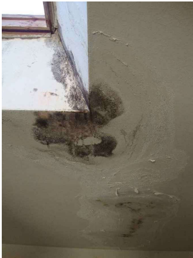
infiltrazione da finestra a tetto
