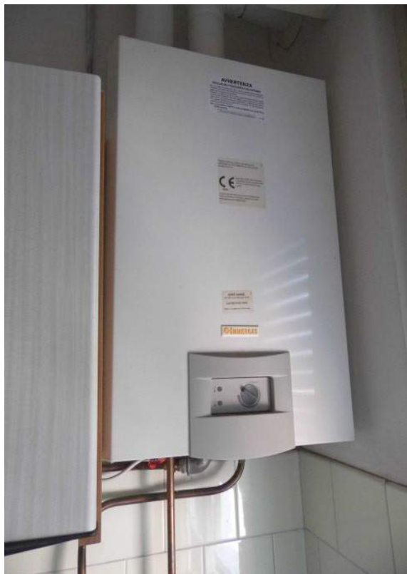
Foto n. 12: cucina particolare caldaia
