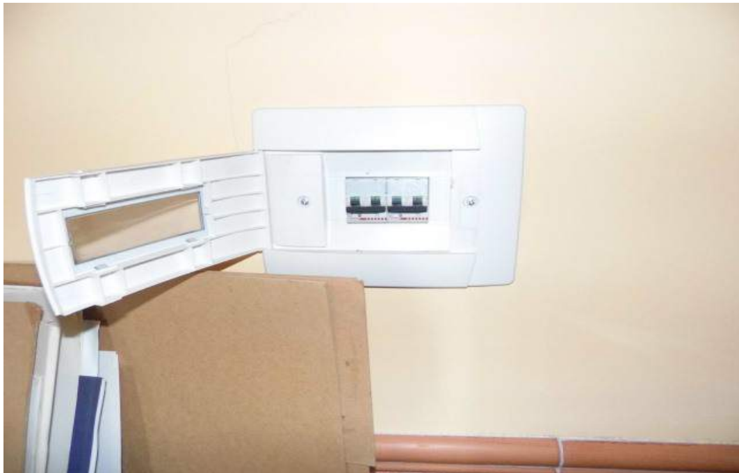
Foto n. 07: ingresso – particolare quadro salvavita
