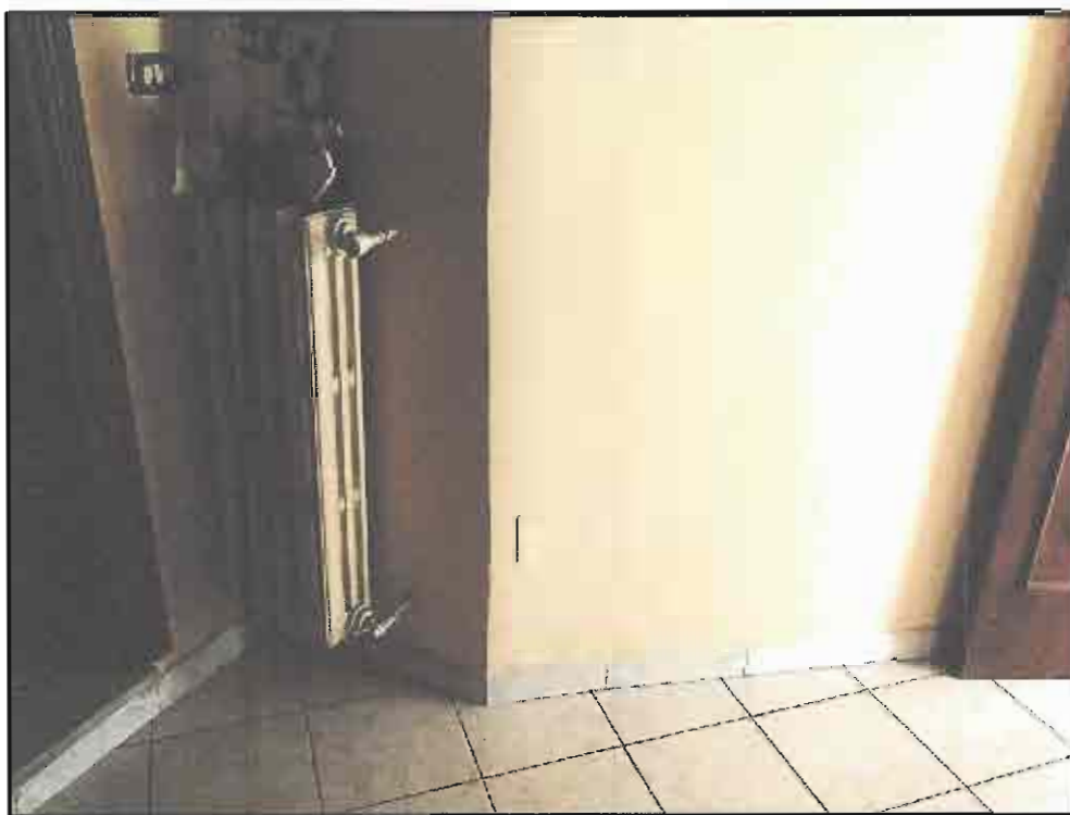
Figura 27: particolare radianti in ghisa.
