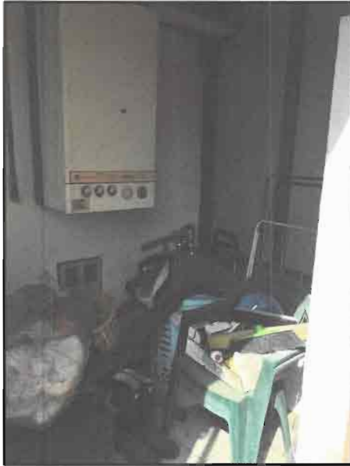
Figura 7: Particolare della caldaia esterna.
