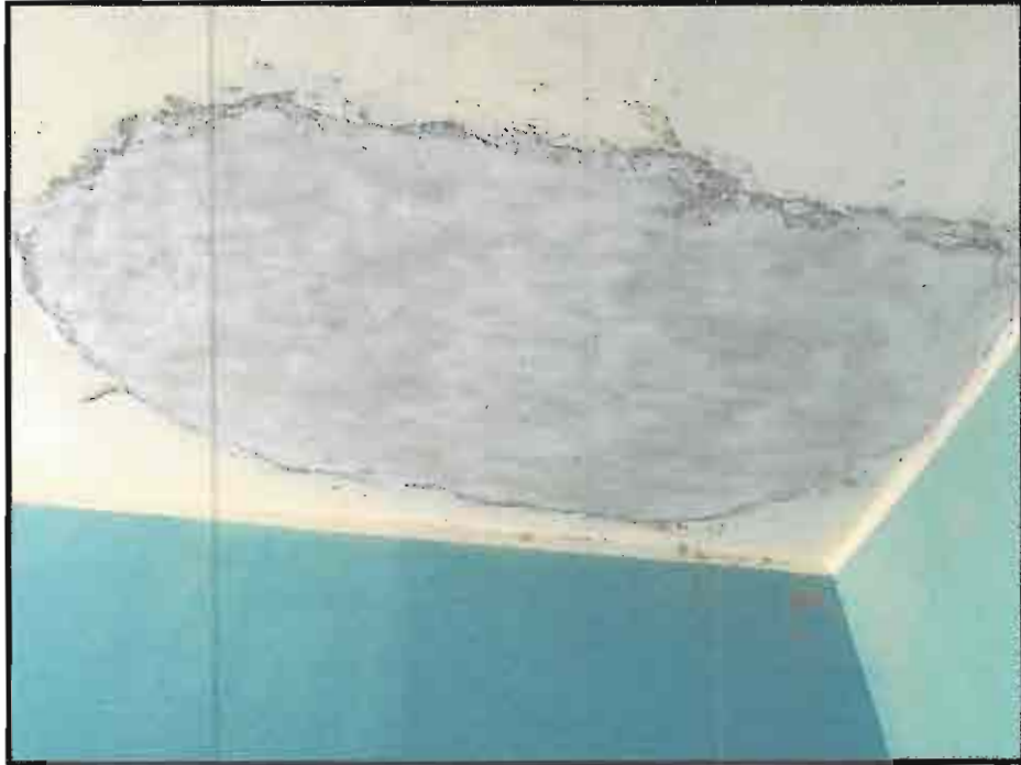
Figura 17: particolare del rappizzo d'intonaco del soffitto nella camera.
