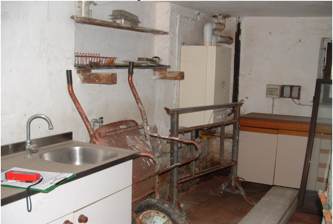
Vista interna locale C.Termica e legnaia
