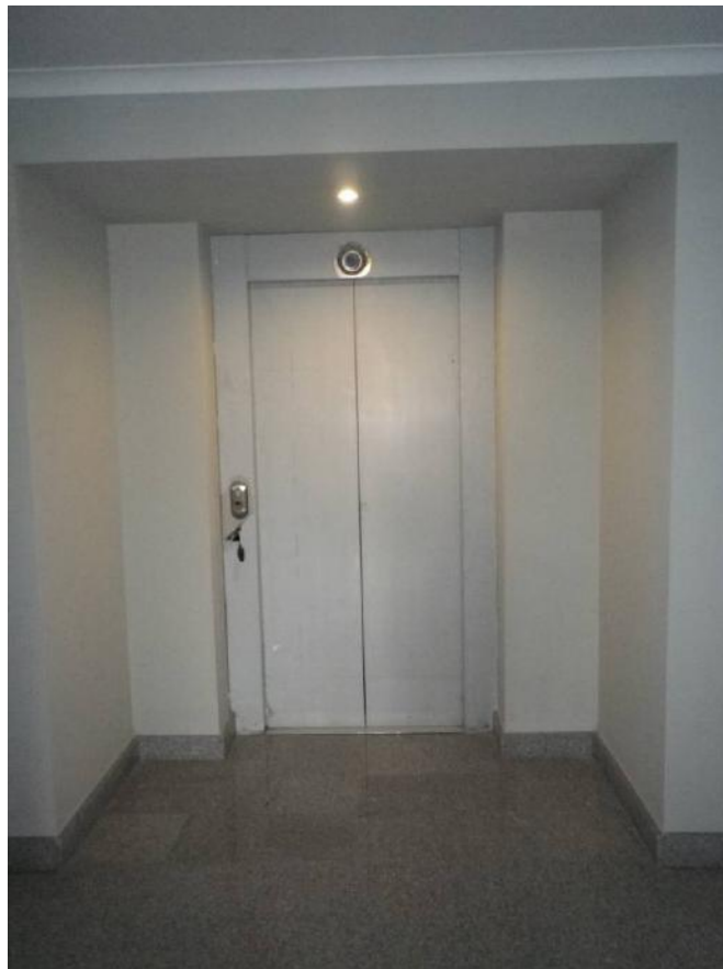
Ascensore condominiale di piano
