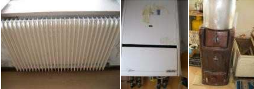
Foto 29-30-31 Dettaglio sistemi di riscaldamento
