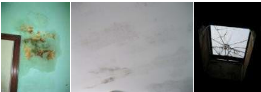
Foto 36-37-38 Interventi di manutenzione urgenti
