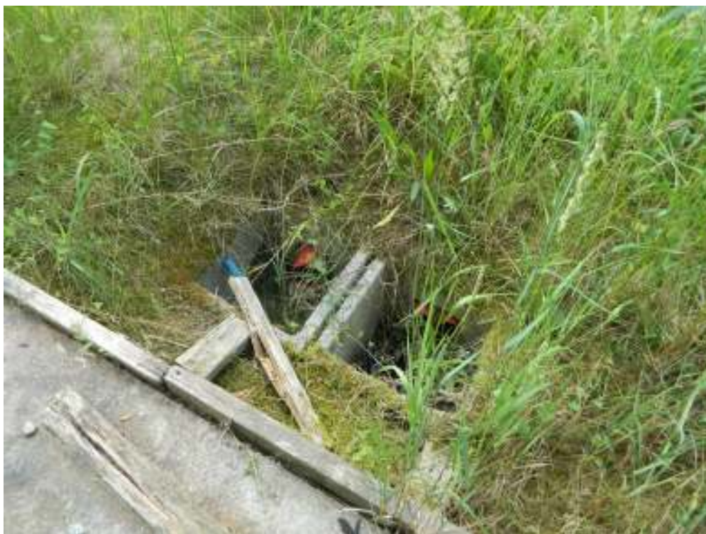
Foto n. 58 – Stato dei luoghi: chiusini di derivazione impianti aperti ed interessati dalla vegetazione.
