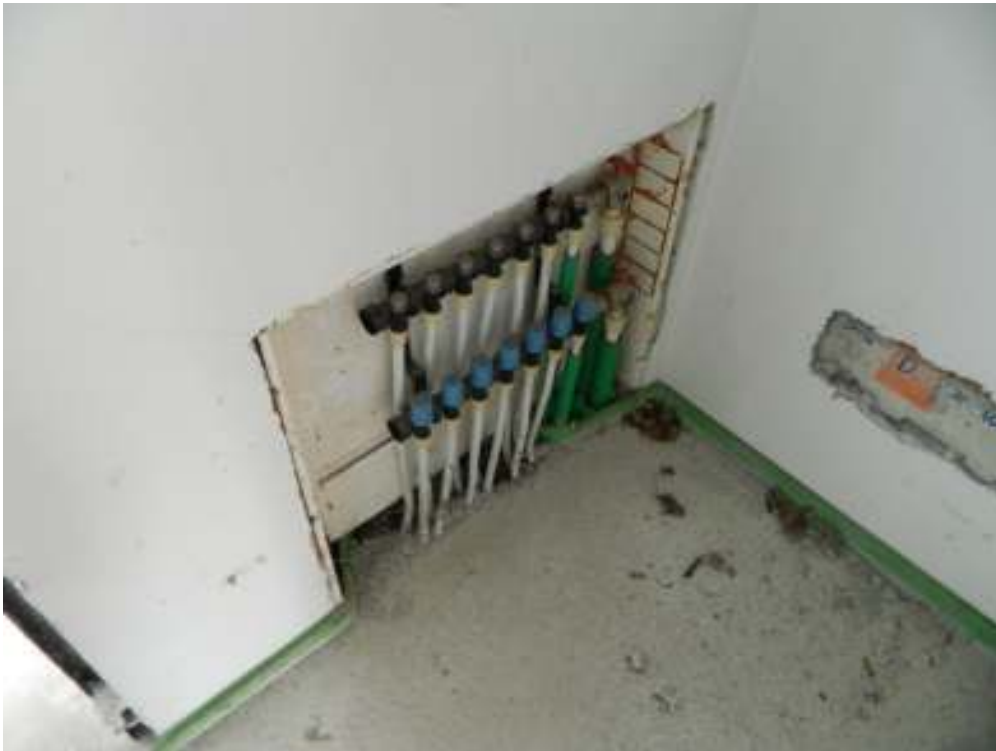
Foto n. 59 – Impianti e predisposizioni.
