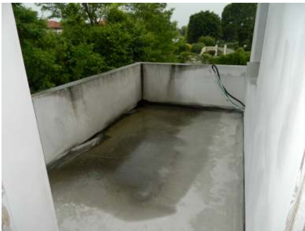
Foto n. 54 – Stato dei luoghi: acqua stagna sui terrazzini.
