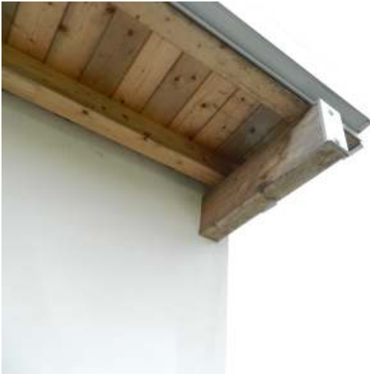
Foto n. 55 – Segni di degrado alle componenti lignee del tetto.
