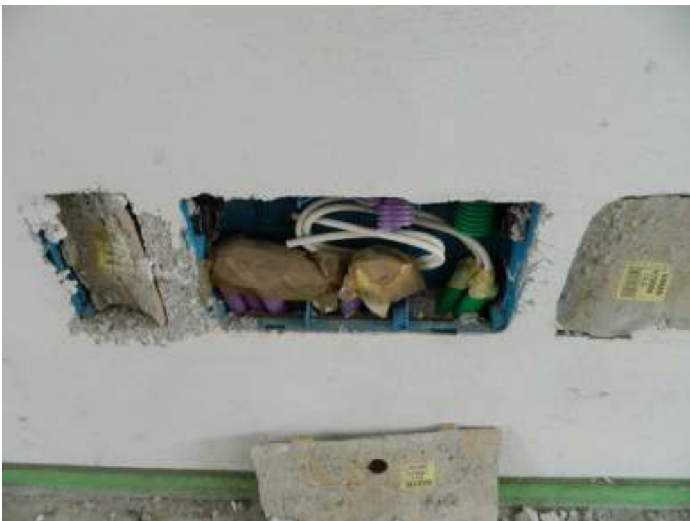
Foto n. 60 – Impianti e predisposizioni.
