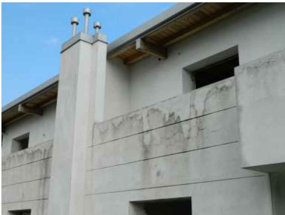
Foto n. 53 – Stato dei luoghi: distacco di intonaco dai terrazzini al piano primo lato nord.
