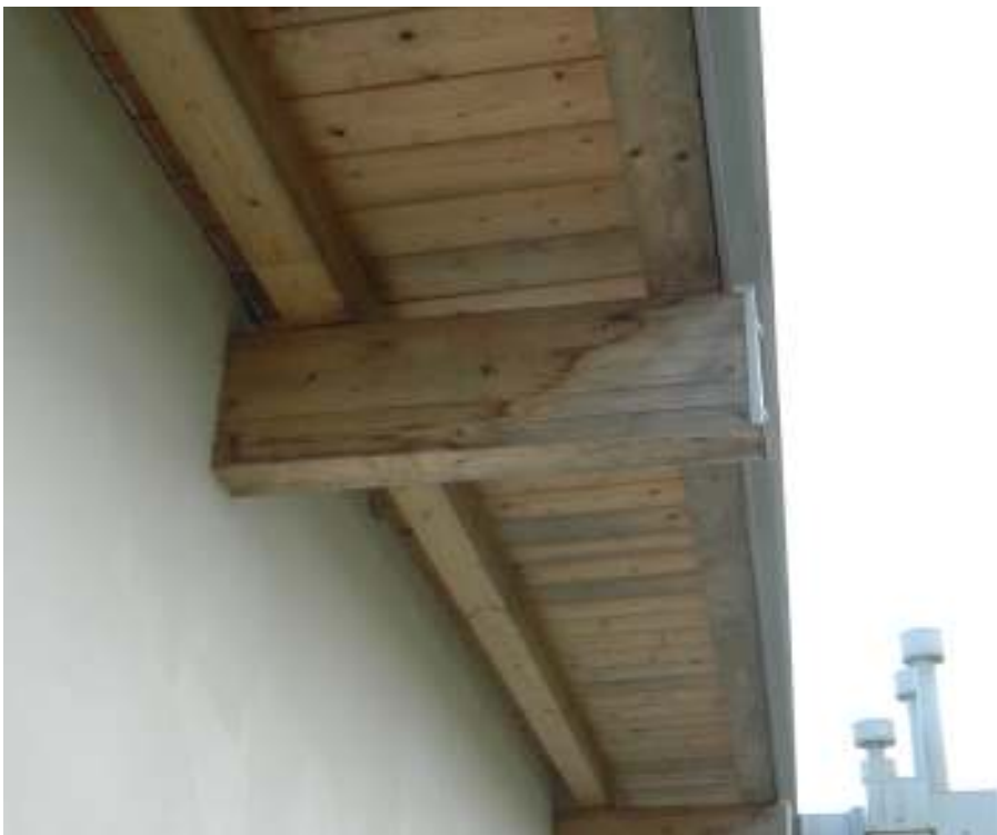
Foto n. 56 – Segni di degrado alle componenti lignee del tetto.
