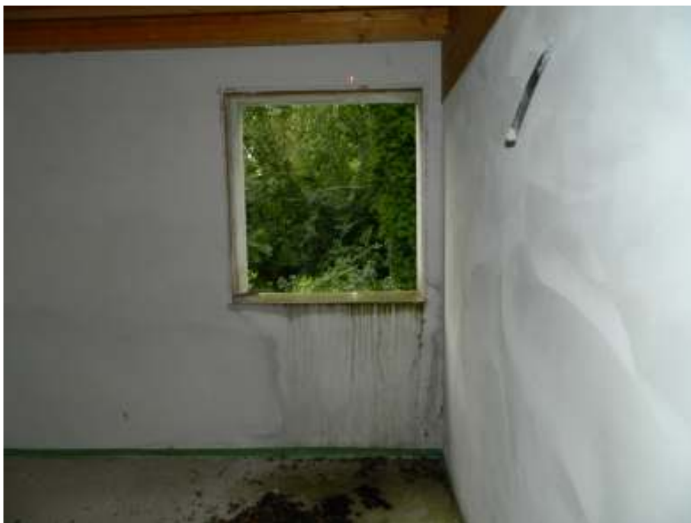
Foto n. 52 – Acqua piovana penetrata della finestra al pino primo lato nord.
