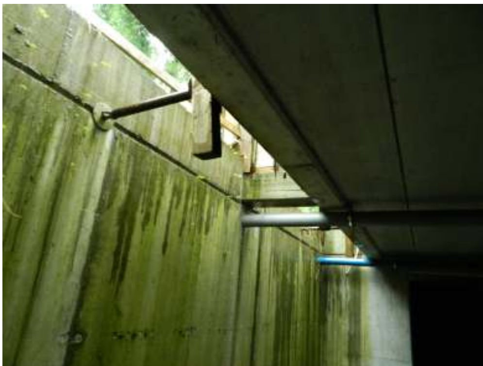
Foto n. 51 – Stato dei luoghi nell'interrato: alghe sulle bocche di lupo a nord.
