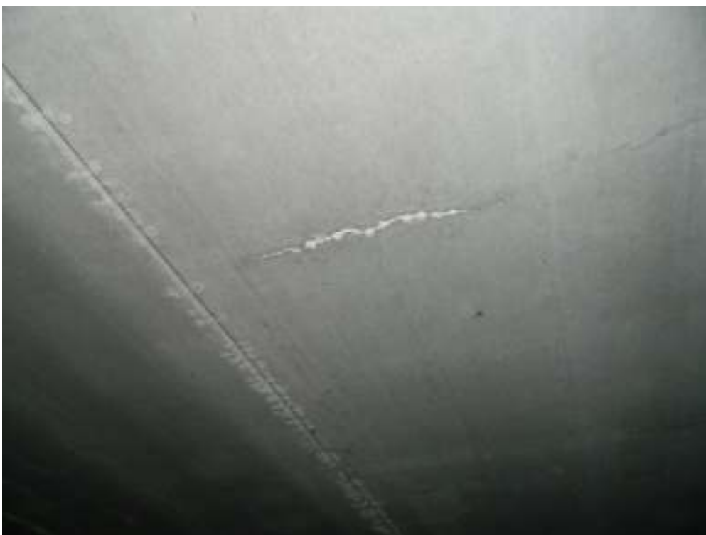
Foto n. 50 – Stato dei luoghi dell'interrato: infiltrazioni dal solaio.
