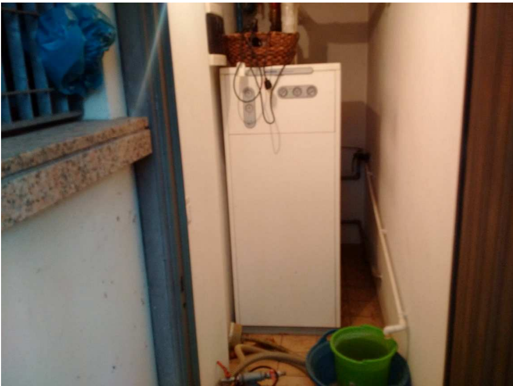
Foto n. 44 – Locale caldaia – piano seminterrato.
