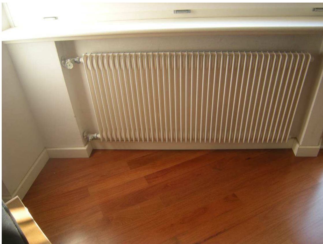
Pordenone, via Nicoletta n. 7 – In alto un particolare dell'impianto elettrico dell'appartamento, in basso il radiatore.
