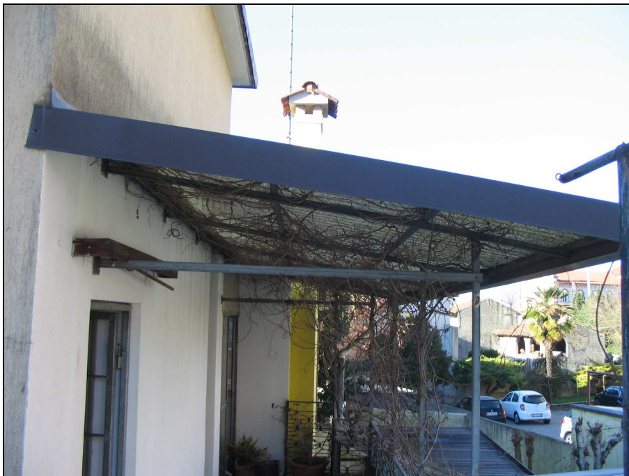
Fig.35: copertura terrazzo piano primo da sanare
