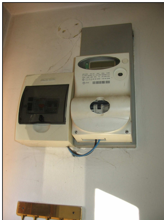
Fig.41: particolare quadro elettrico in entrata
