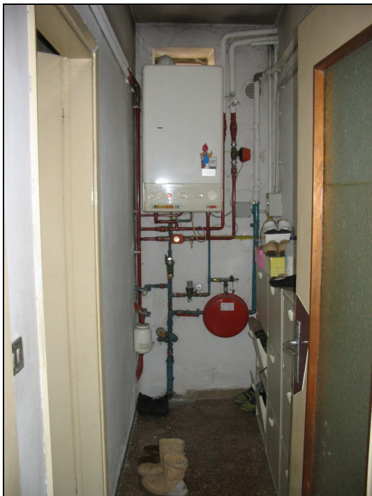
Fig.14: disimpegno bagno con caldaia
