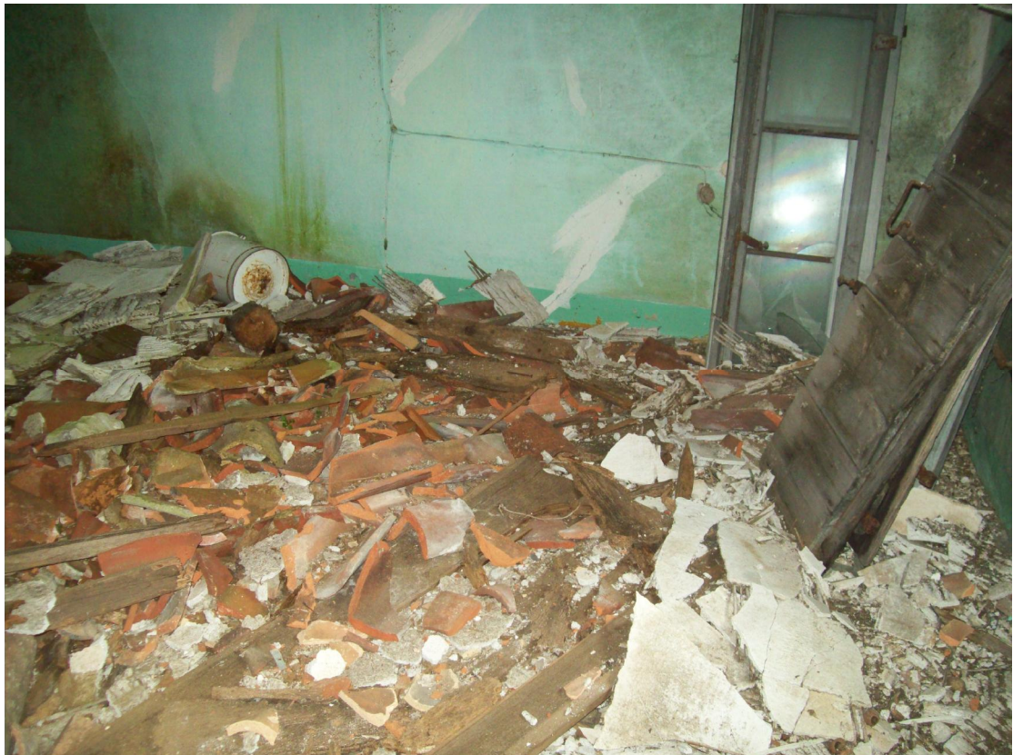
Foto 32: Detriti sul solaio
