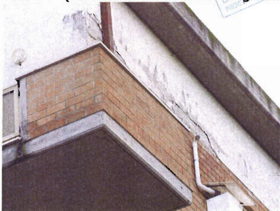
Foto 14 (Paramenti condominiali degradati)
