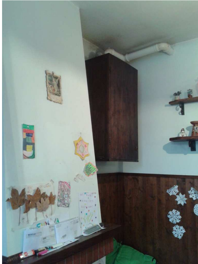
Foto 21: Contenitore caldaia interna
