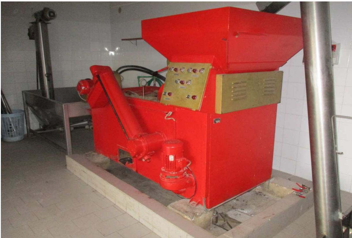
frantoio con tramoggia e coclea di collegamento con macina
