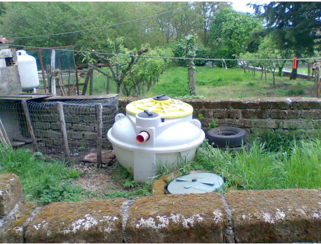
BOMBOLA INTERRATA DEL GAS
