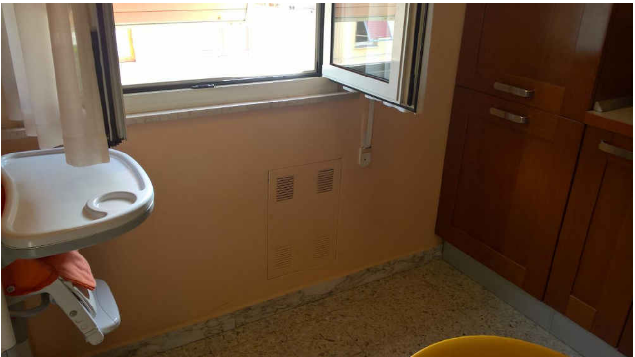
Centralina rilevatore gas (16)
