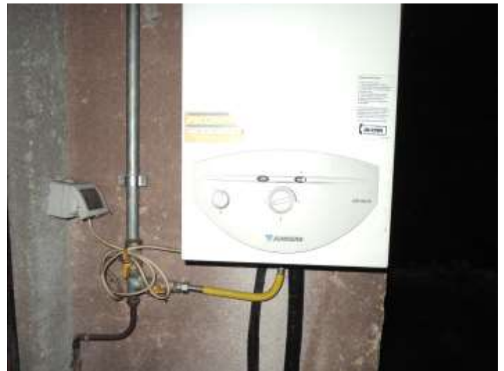
Particolare Caldaia per la produzione di acqua calda sanitaria
