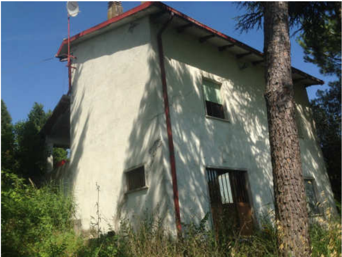
retro del fabbricato (si noti l'importante crepa sullo spigolo)
