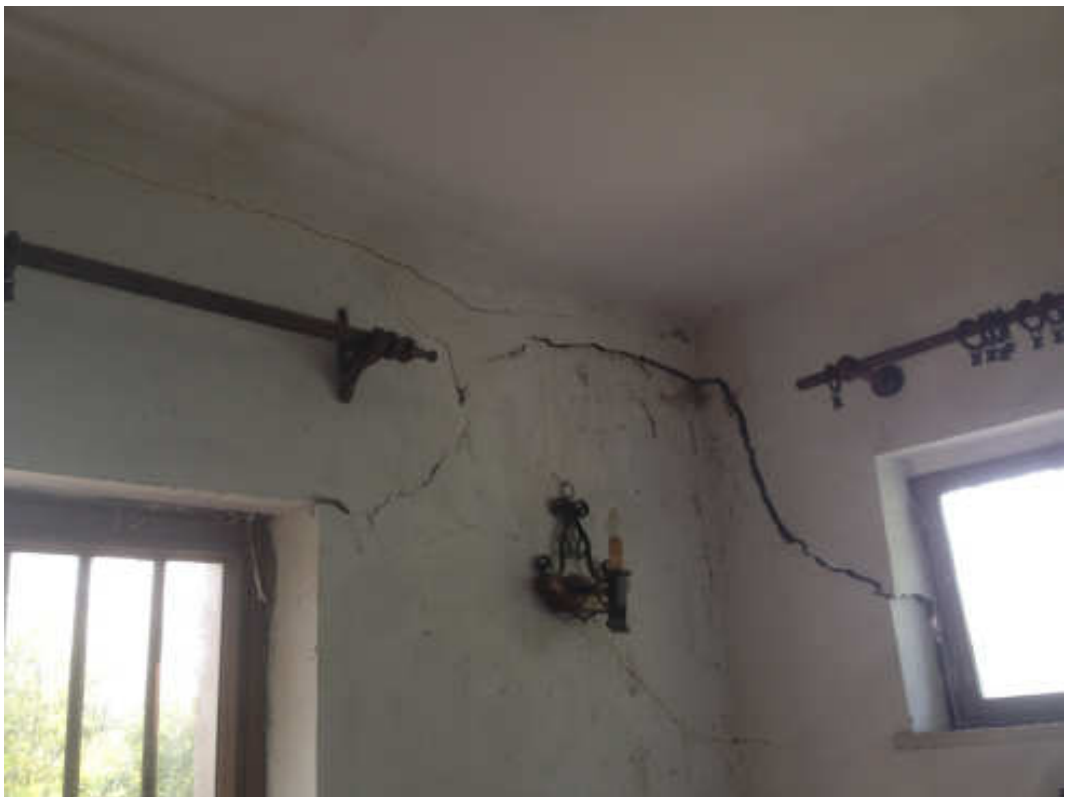
crepa spigolo sud/ovest
