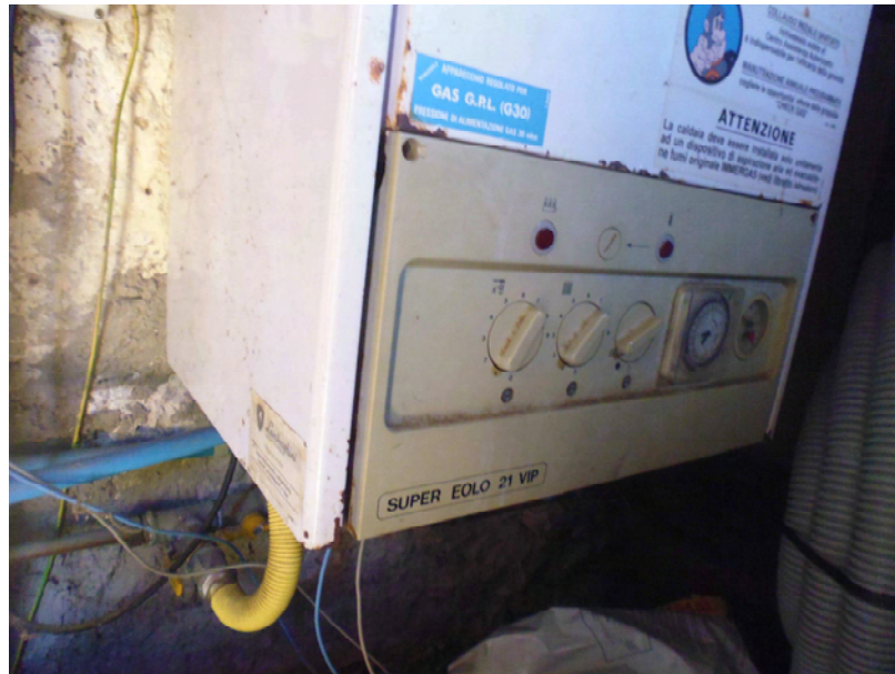
Vista 17 : Caldaia murale posizionata nel locale cantina
