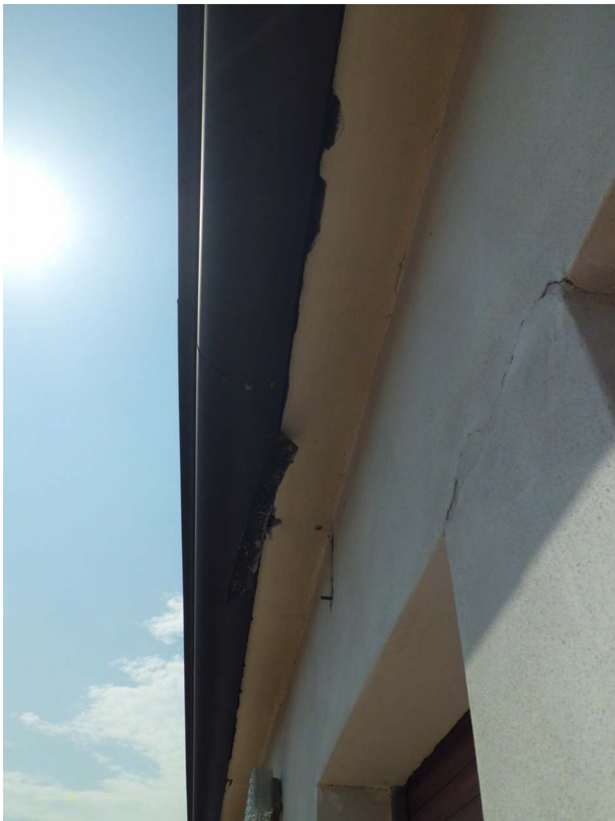
Foto n° 27 - 01/07/2016 - Comune di San Quirino, foglio 59, part. 57 sub.3 - Particolare della grondaia esterna danneggiata. Fotografia scattata dalla terrazza.
