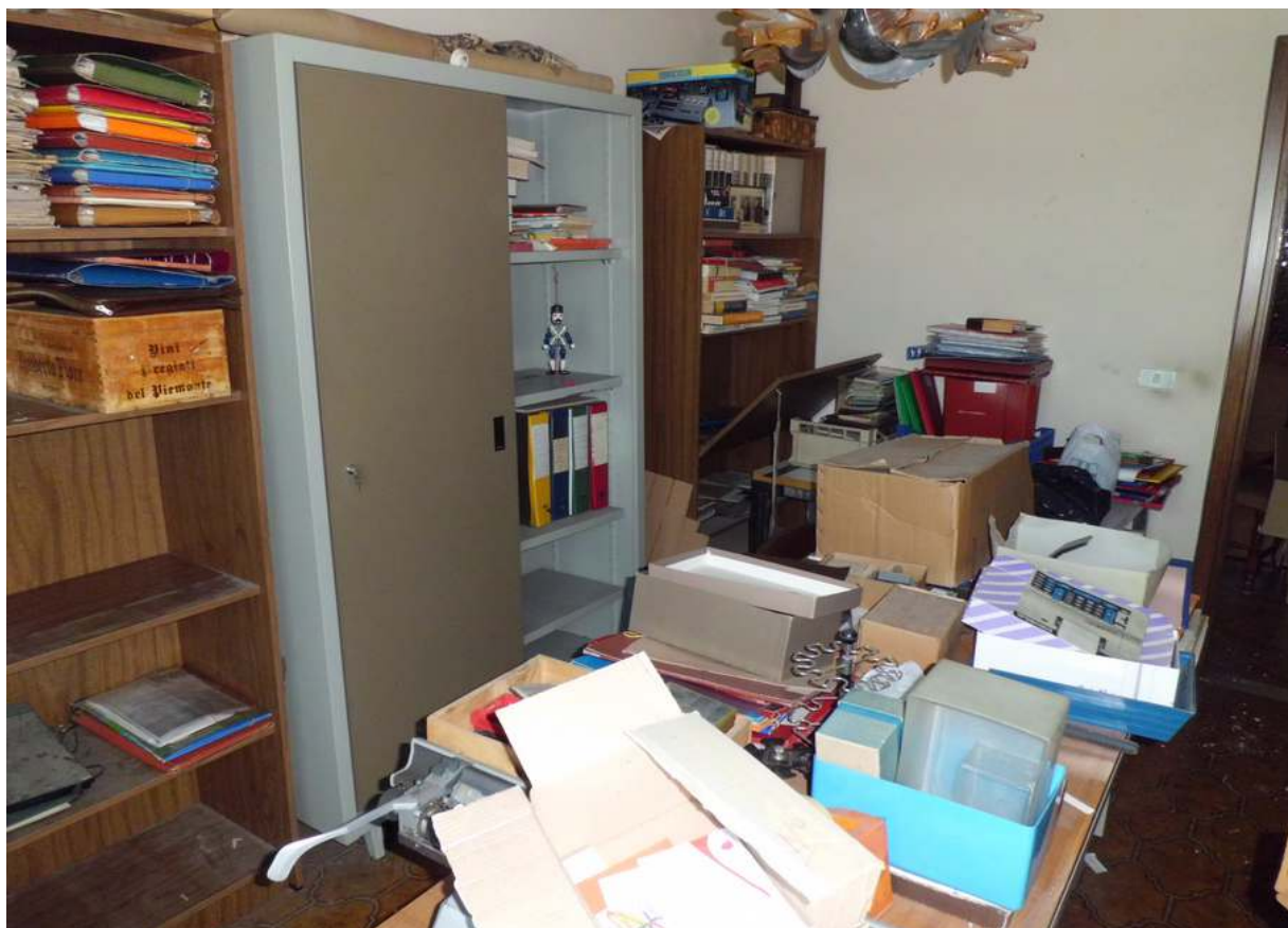
Foto n° 16 - 01/07/2016 - Comune di San Quirino, foglio 59, part. 57 sub.3 - Stanza adibita a studio e catastalmente indicata come camera. Nella stanza sono presenti danneggiamenti dovuti all'umidità e crepe sui muri. Foto scattata dalla porta che immette nella terrazza.
