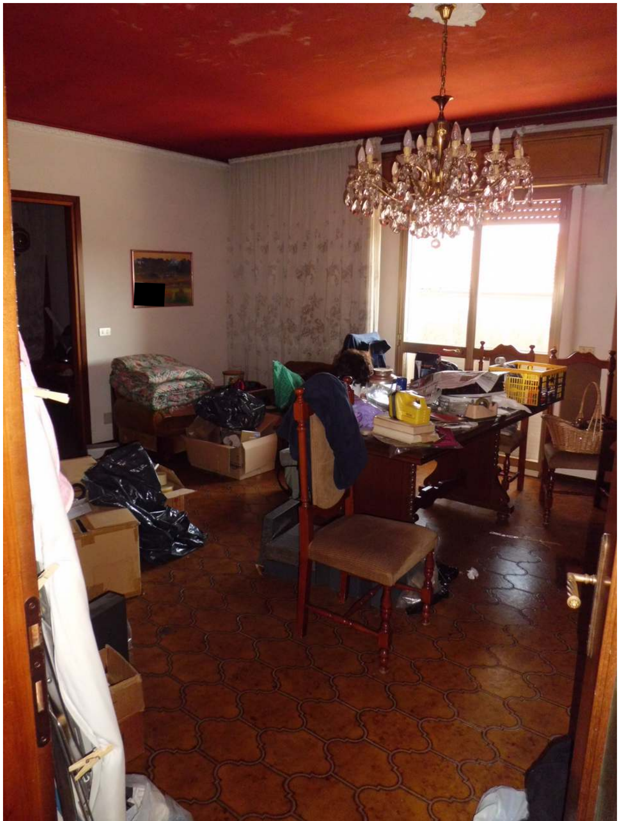
Foto n° 13 - 01/07/2016 - Comune di San Quirino, foglio 59, part. 57 sub.3 - Sala da pranzo. Sul soffitto sono presenti macchie causate dall'umidità. In fondo a sinistra è visibile la porta che dà accesso al salottino della foto successiva.
