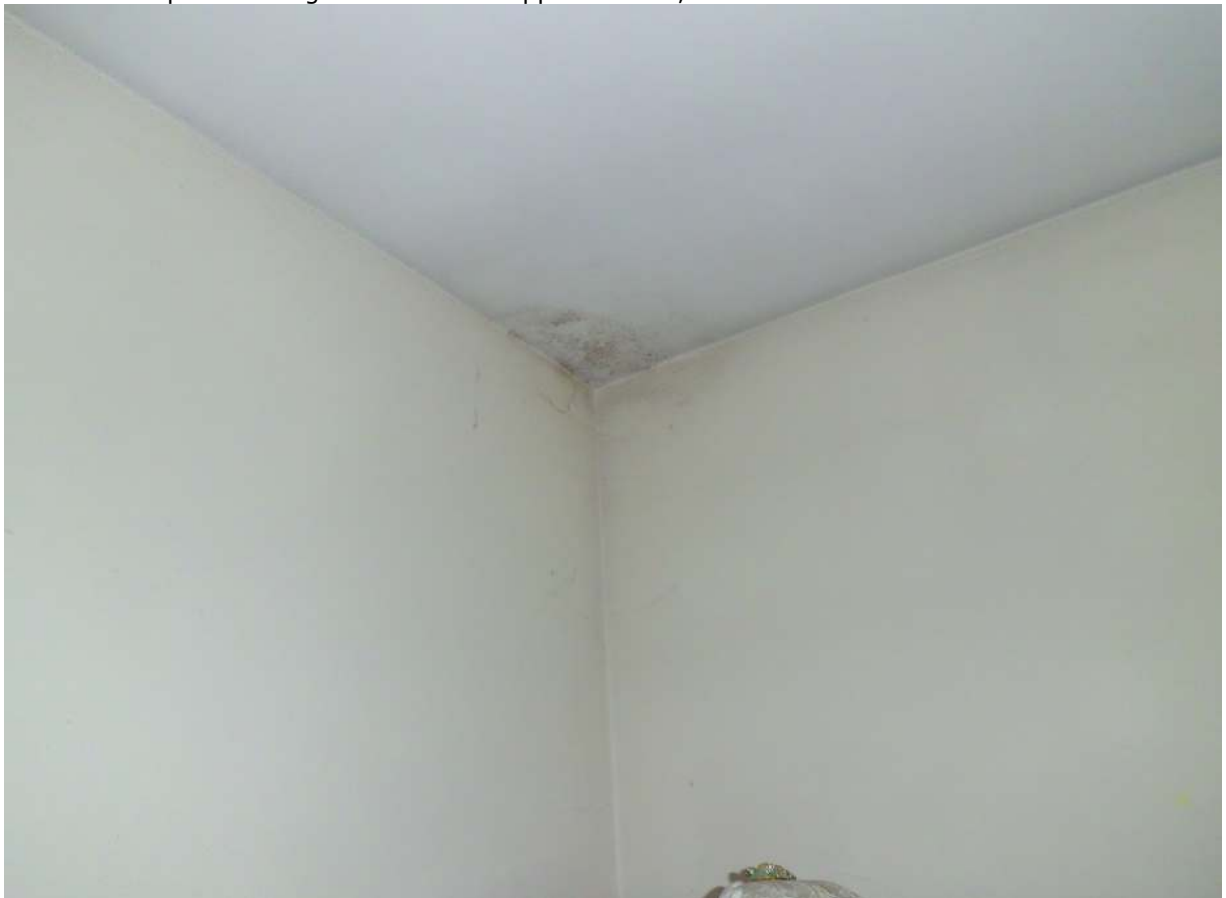
Foto n° 20 - 01/07/2016 - Comune di San Quirino, foglio 59, part. 57 sub.3 - Muffa sui muri della camera posta all'angolo sud est dell'appartamento, catastalmente indicata come salotto.
