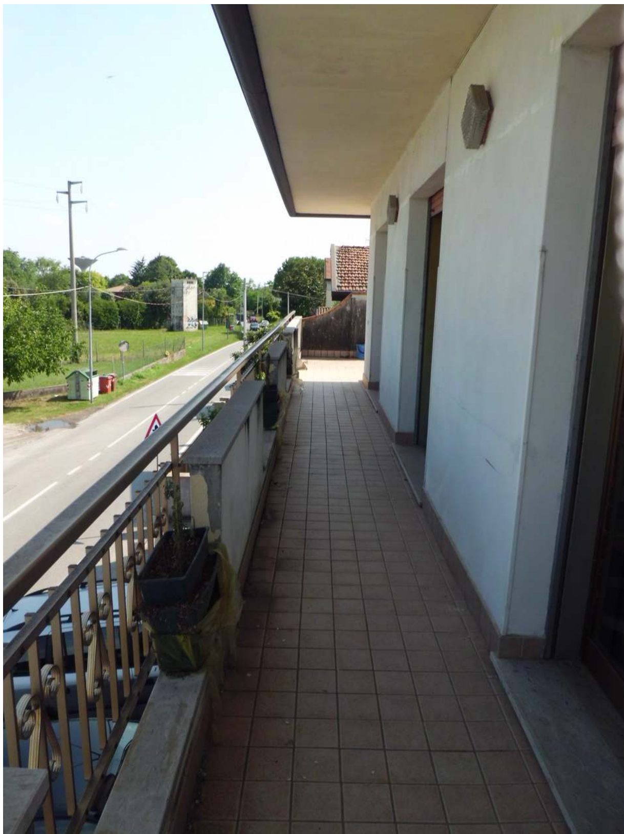
Foto n° 23 - 01/07/2016 - Comune di San Quirino, foglio 59, part. 57 sub.3 – Porzione della terrazza esterna, lato fronte strada. Le piastrelle risultano sollevate in più punti. Sui muri sono presenti delle crepe e l'intonaco esterno risulta danneggiato in diverse zone.
