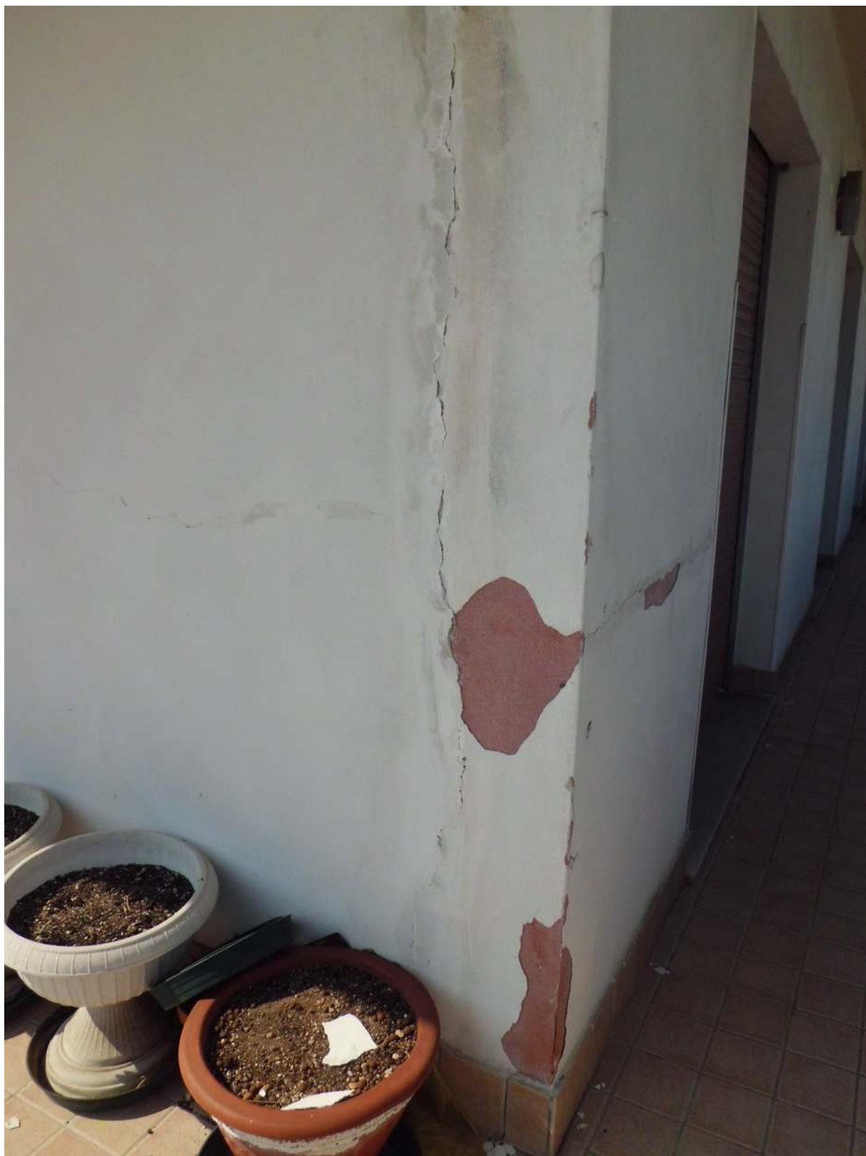
Foto n° 24 - 01/07/2016 - Comune di San Quirino, foglio 59, part. 57 sub.3 - Evidenti danneggiamenti ai muri ed intonaci esterni che risultano bisognosi di manutenzione.
