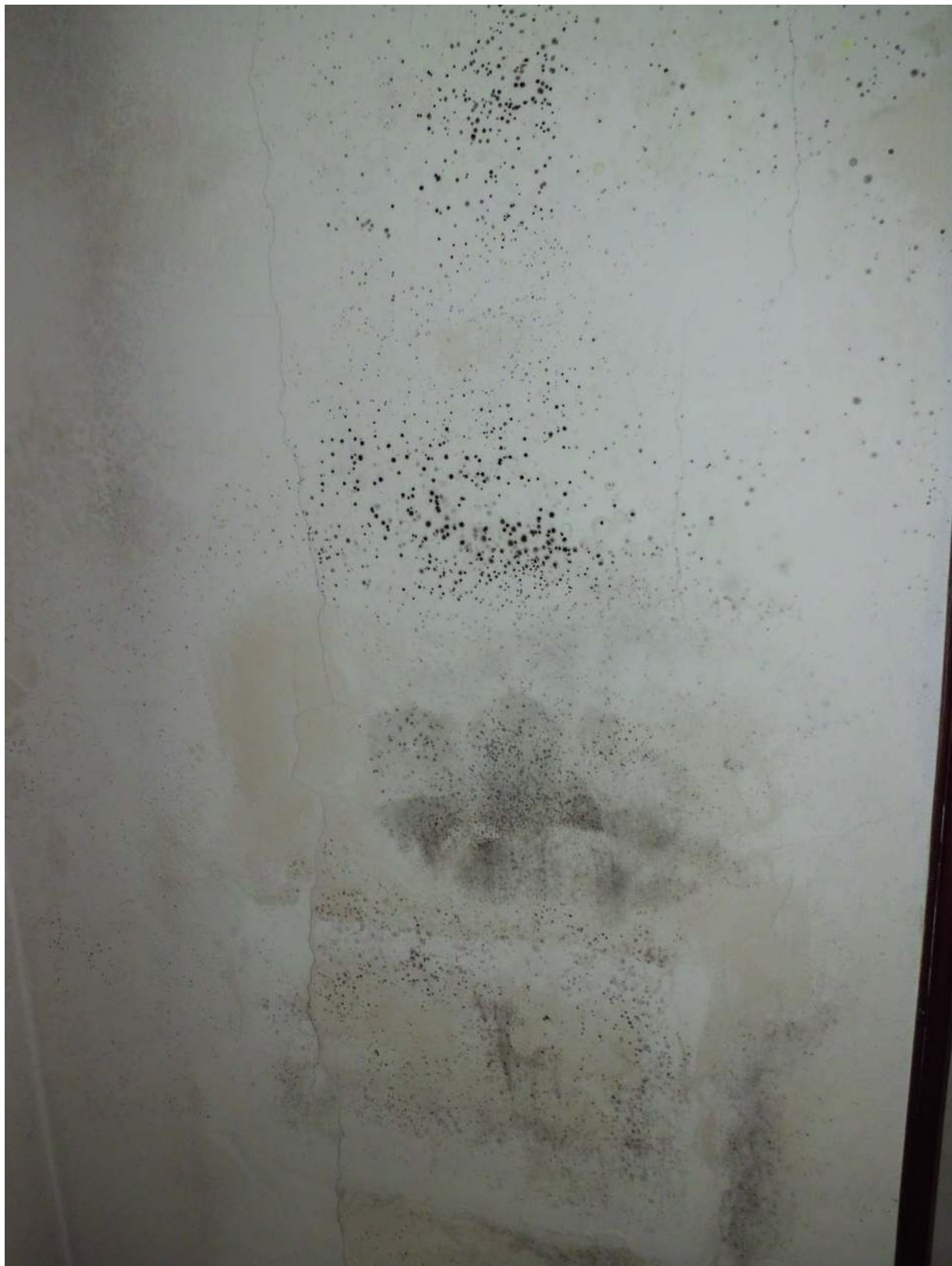
Foto n° 18 - 01/07/2016 - Comune di San Quirino, foglio 59, part. 57 sub.3 - Umidità e muffa presente sulle pareti della stanza adibita a studio.
