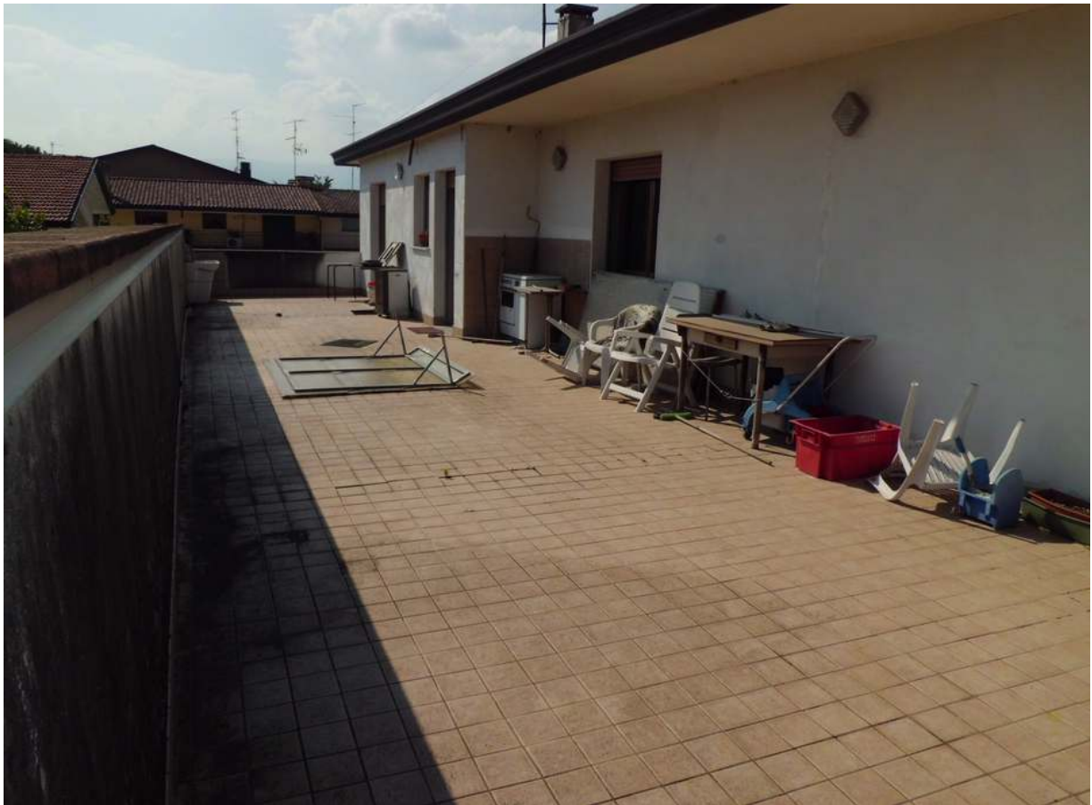
Foto n° 25 - 01/07/2016 - Comune di San Quirino, foglio 59, part. 57 sub.3 - Terrazza esterna, porzione ovest. Il pavimento risulta sollevato in più punti. Le piastrelle sono a volte danneggiate.
