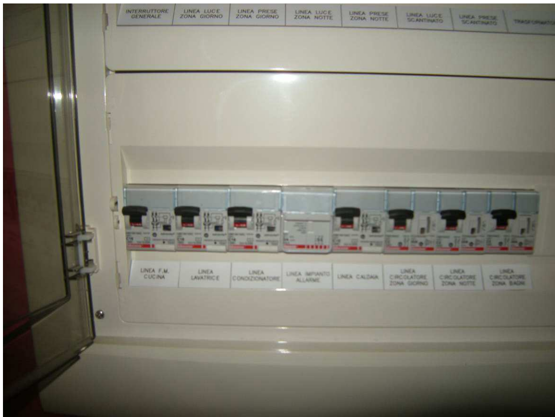
Roveredo in Piano, via I. Nievo 3/H – Il quadro elettrico dell'impianto dell'appartamento.
