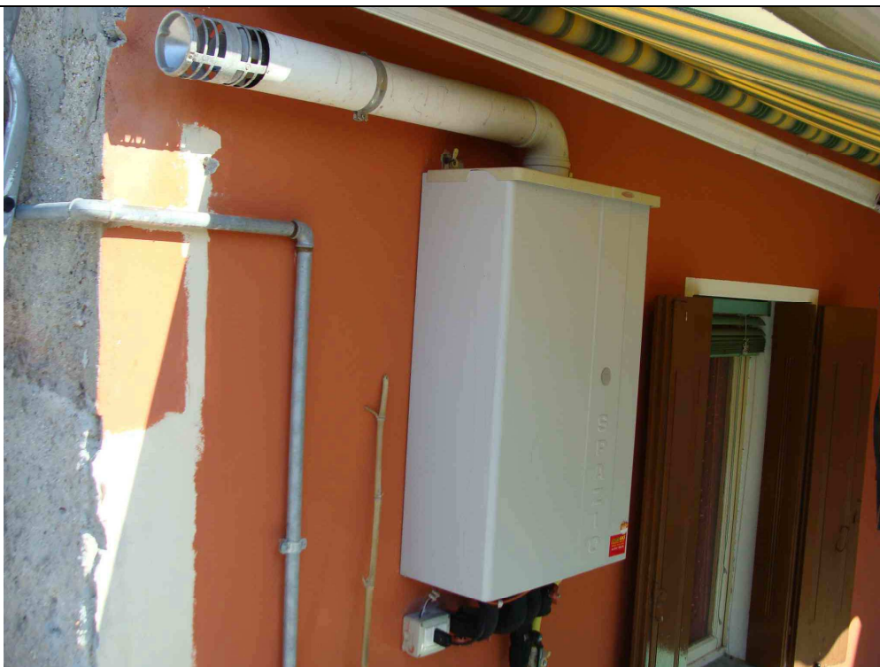
Particolare caldaia esterna
