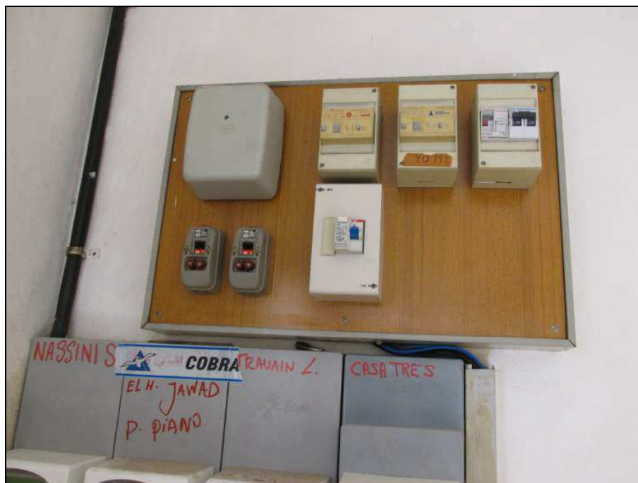
Fig.9: Particolare quadretti elettrici generali in entrata del vano scale
