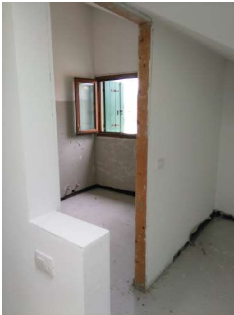
FOTO 19_SOFFITTA_LOCALE CON PREDISPOSIZIONE IMPIANTI BAGNO NON AUTORIZZATO
