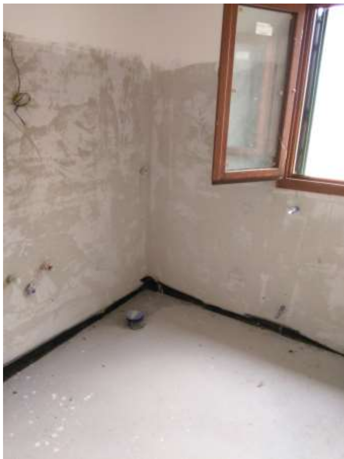
FOTO 20_SOFFITTA_LOCALE CON PREDISPOSIZIONE IMPIANTI BAGNO NON AUTORIZZATO
