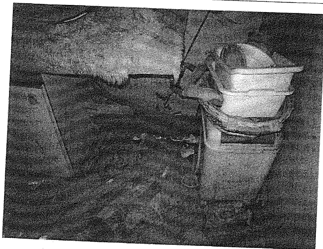
Pordenone via Brugnera n. 35 – Il vano tecnico adibito a centrale termica.
