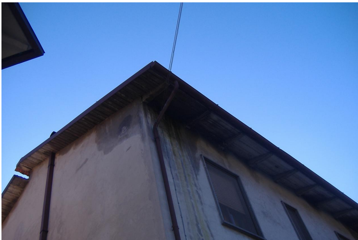
PARTICOLARE FACCIATA CON UMIDITA' IN CORRISPONDENZA DELLA CAMERETTA
