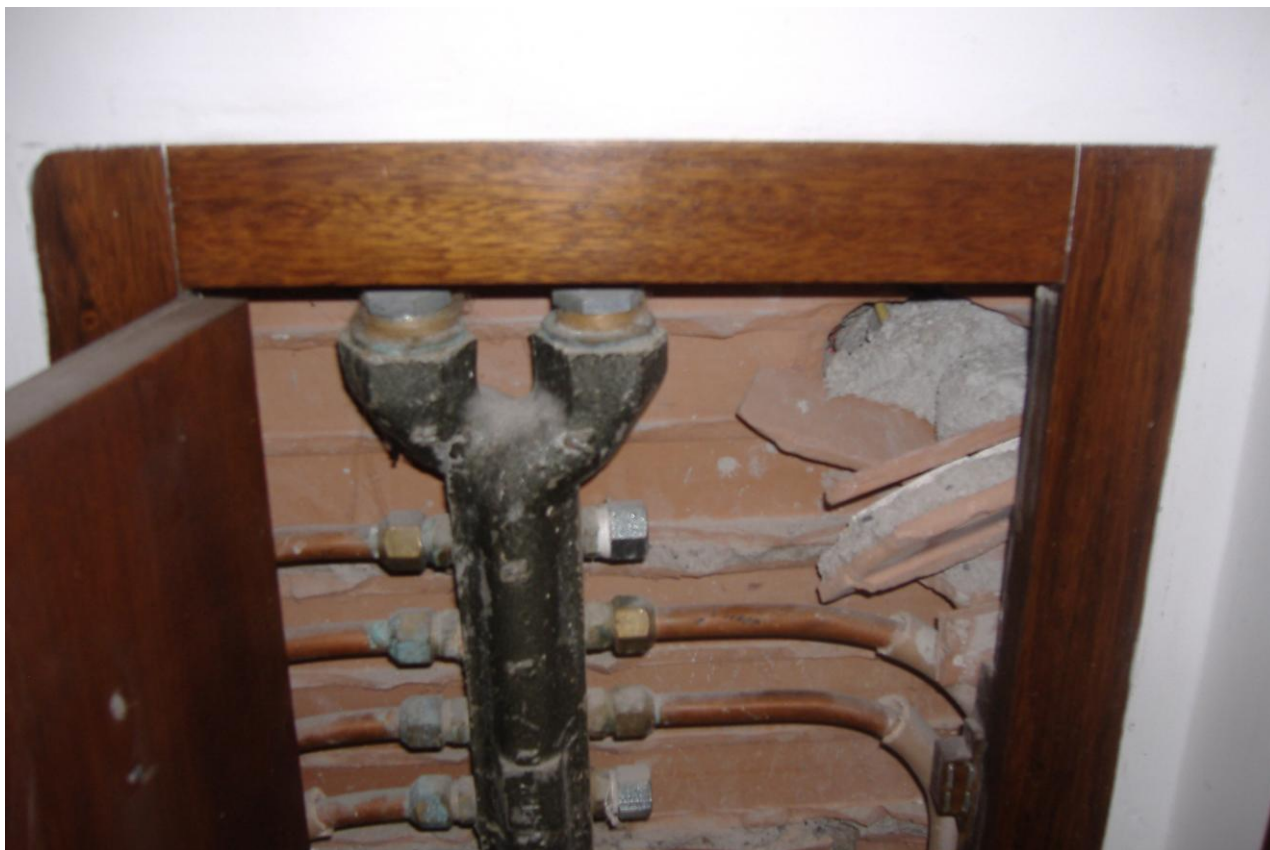
CENTRALINA TERMOSIFONE (NON ATTIVA PER MANCANZA DI GAS)
