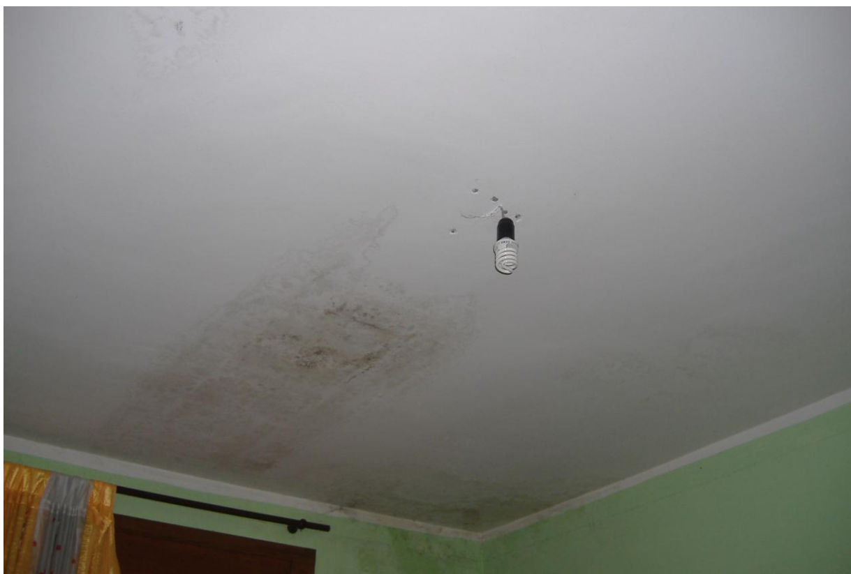
SOFFITTO CAMERETTA CON UMIDITA'
