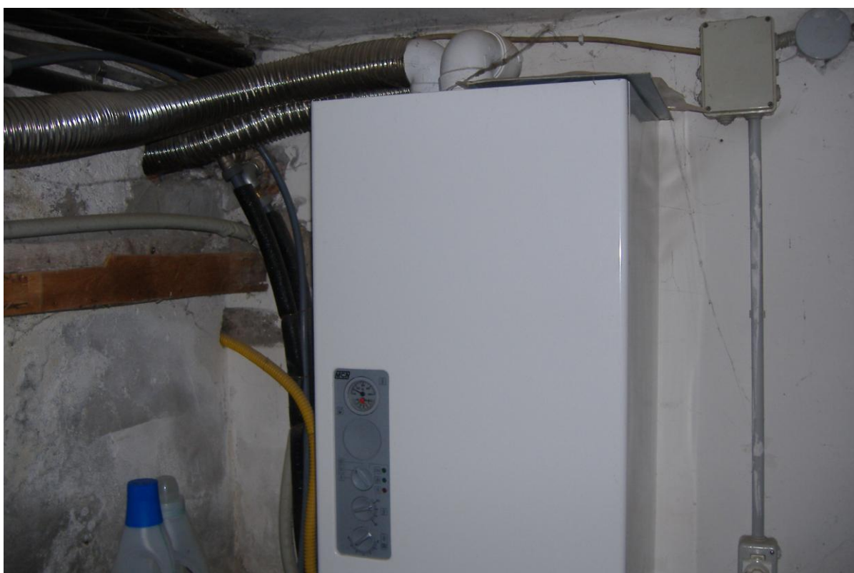
PARTICOLARE CALDAIA FUNZIONANTE MA NON COLLEGATA ALLA RETE GAS
