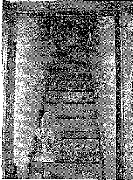
scala non presente nell'autorizzazione a costruire del 1962.
