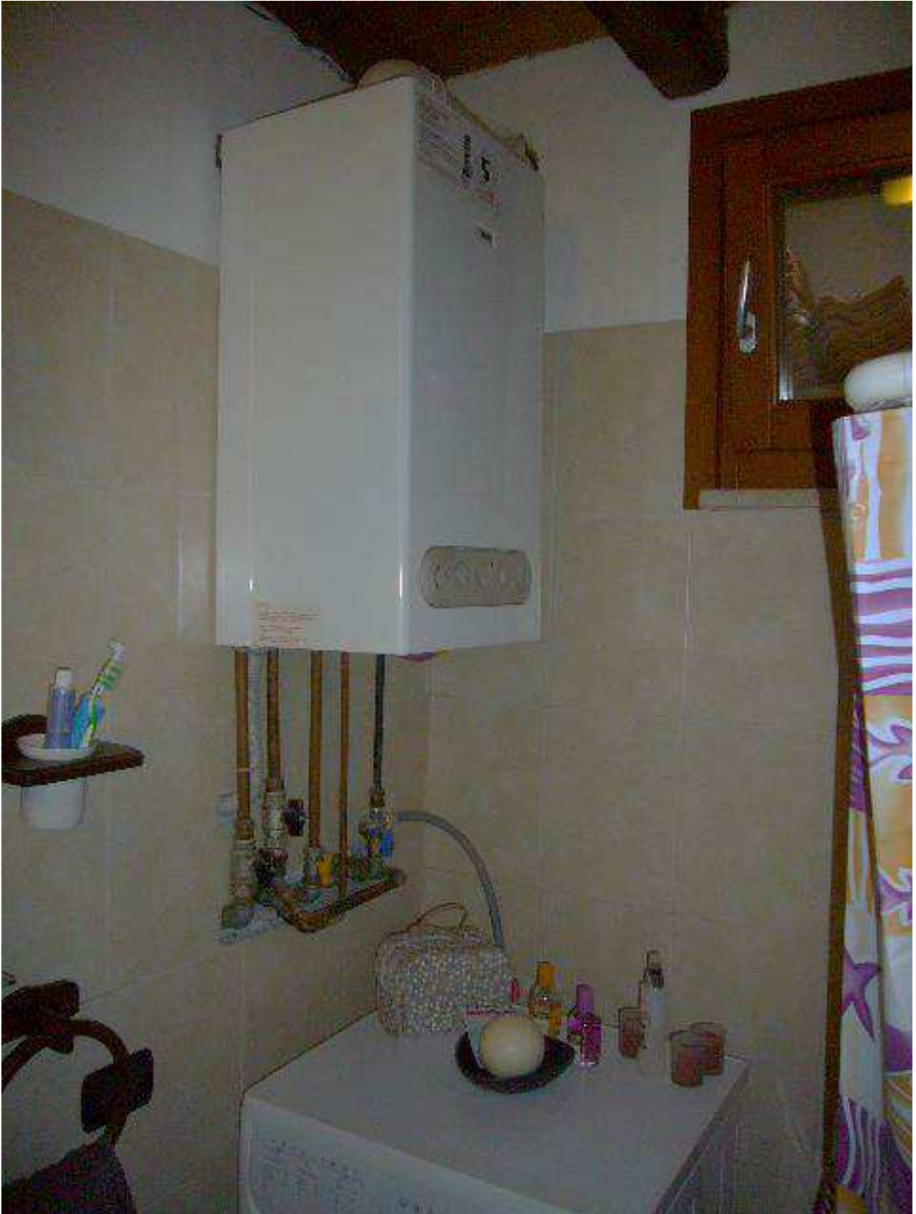
CENTRALE TERMICA PIANO TERRA
