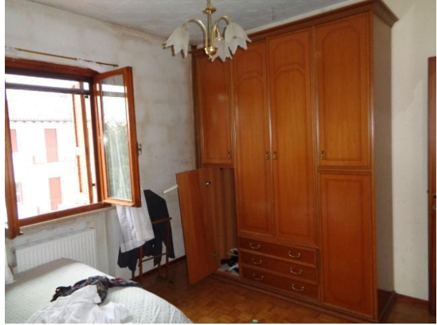
particolare degrado della muratura e soffitto con muffa nella camera principale
