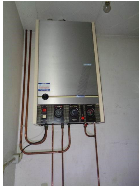
vista interna della caldaia nel ripostiglio
