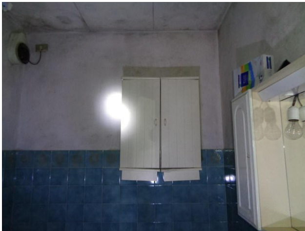
particolare degrado della muratura e soffitto con muffa nel wc
