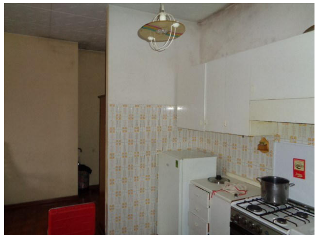
particolare degrado della muratura con muffa nella cucina
