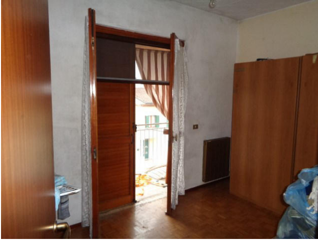
particolare degrado della muratura e soffitto con muffa nella cameretta
