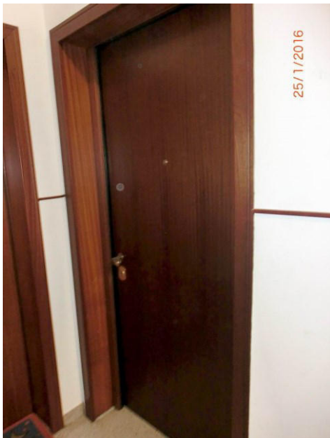
particolare porta blindata di ingresso
