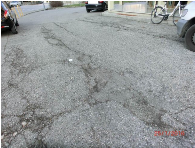
particolare degrado asfaltatura nel piazzale e parcheggio fronte fabbricato
