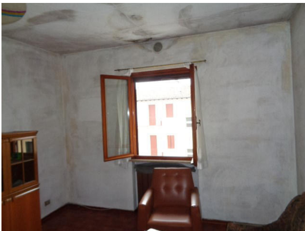
particolare degrado della muratura e soffitto con muffa nel pranzo-soggiorno
