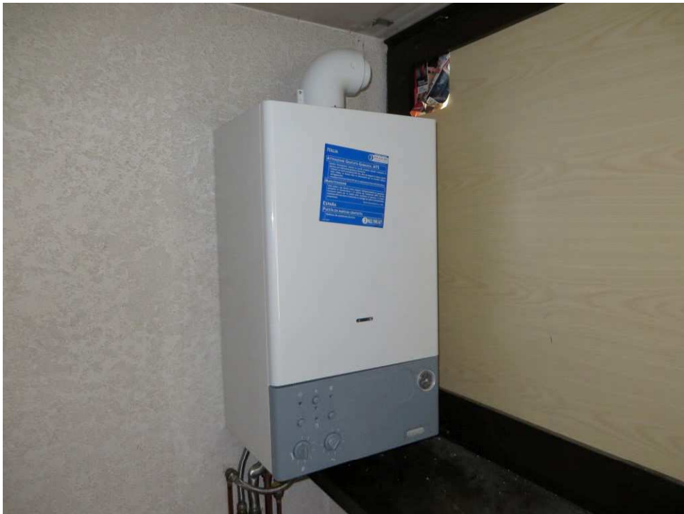
FOTO 16: CALDAIA (SUB. 16 AL 2° P.)
