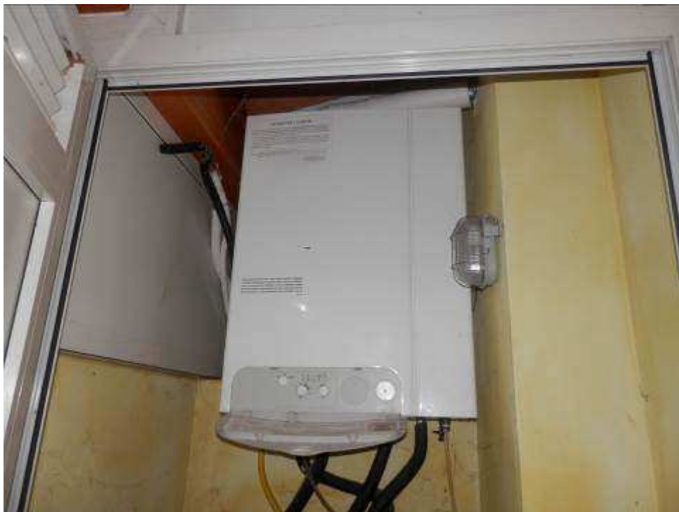
Foto 20-21: Caldaia riscaldamento e terrazze esterne.
