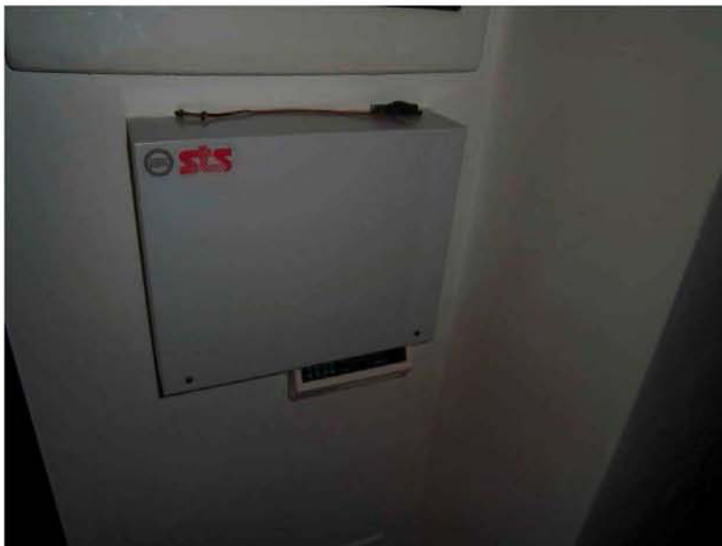
FOTO 22: CENTRALE IMPIANTO D'ALLARME
