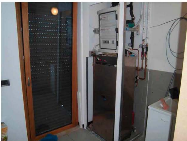
FOTO 19: CALDAIA IMPIANTO DI RISCALDAMENTO
