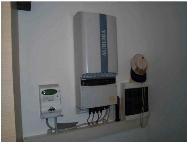
FOTO 20: QUADRO IMPIANTO ELETTRICO
