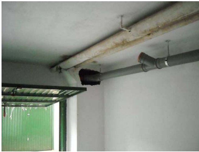
Foto 30 e 31, particolare tubazioni presenti nel soffitto del garage
